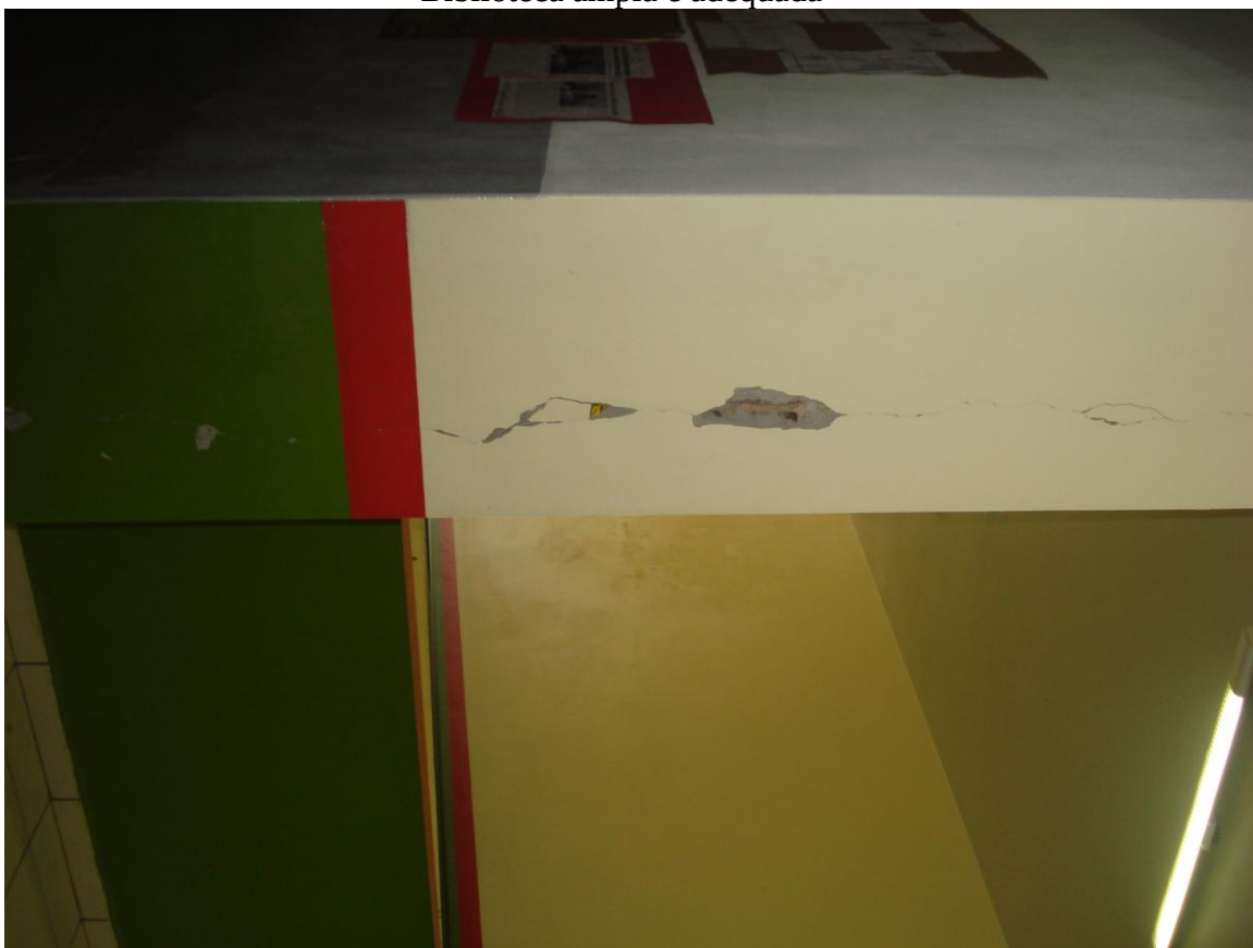
Rachaduras na estrutura
