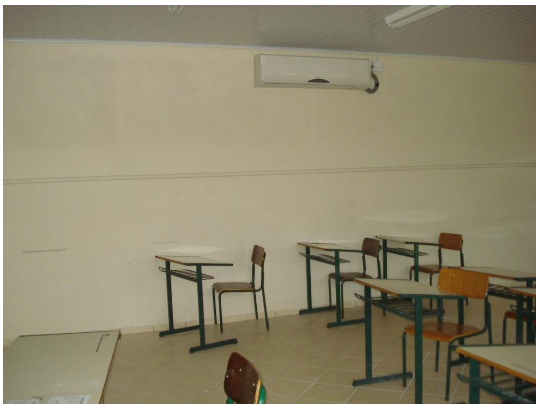
Climatizador em apenas uma sala de aula, que não é ligado por falta de condições da instalação elétrica
