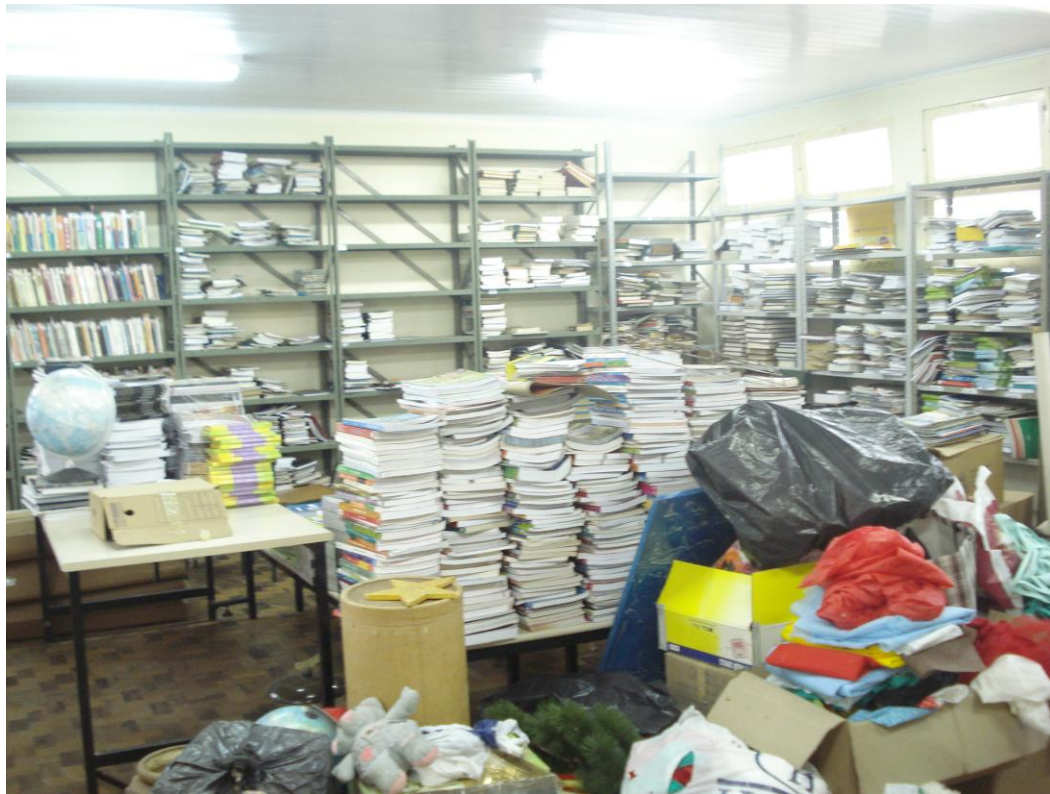
Biblioteca adequada, porém, servindo de depósito.
