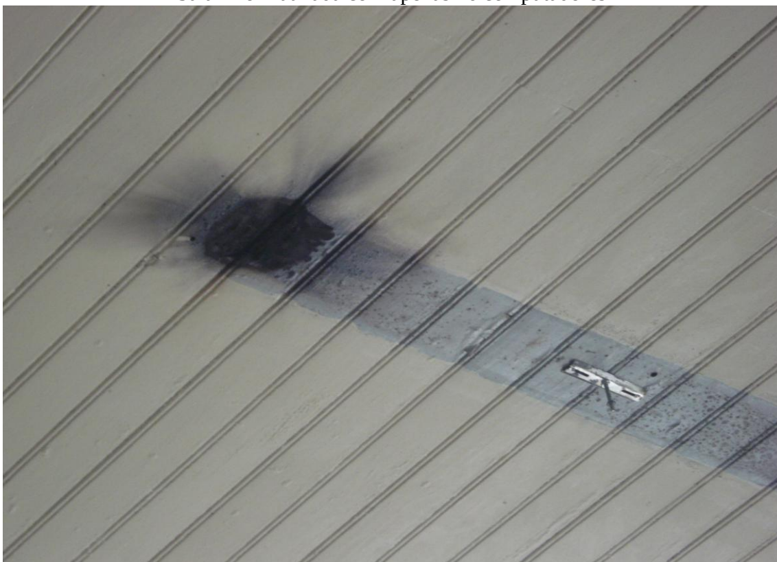
Rede elétrica em péssimas condições.
