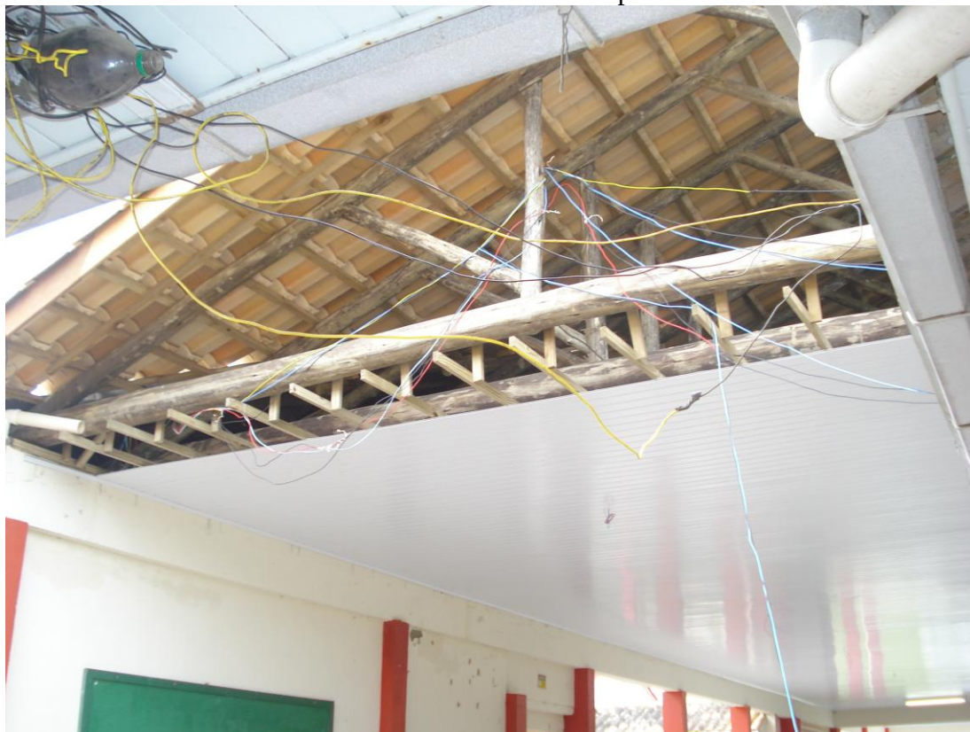
Forro da área coberta caiu e atualmente encontra-se em reforma.
