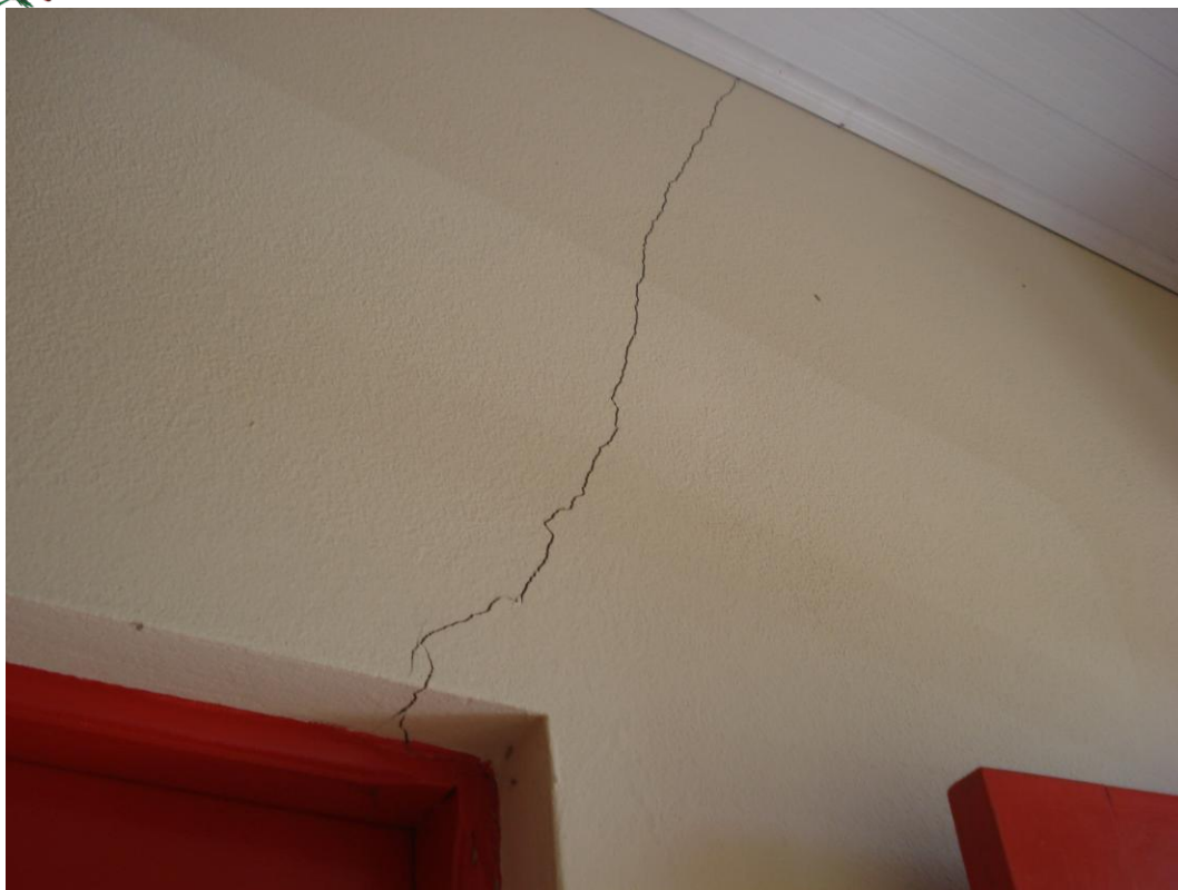
Rachaduras nas paredes
