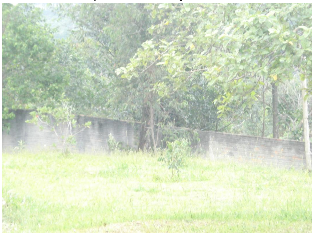
Muro baixos permitem a entrada de vândalos na escola.
