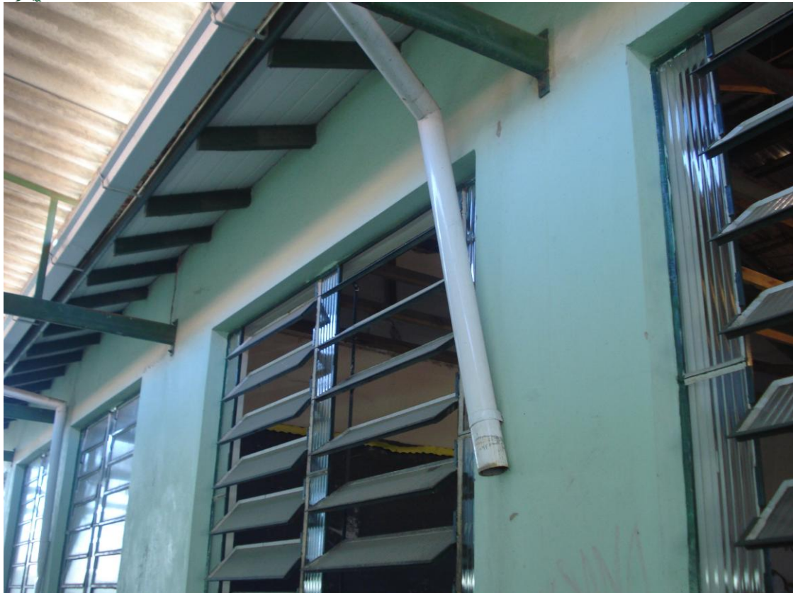
Calhas de chuva quebradas
