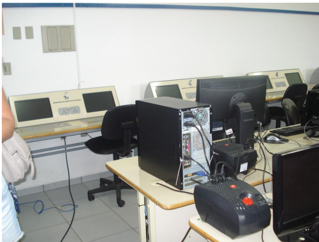
Sala informatizada sem climatizador por falta de condições da rede elétrica.
