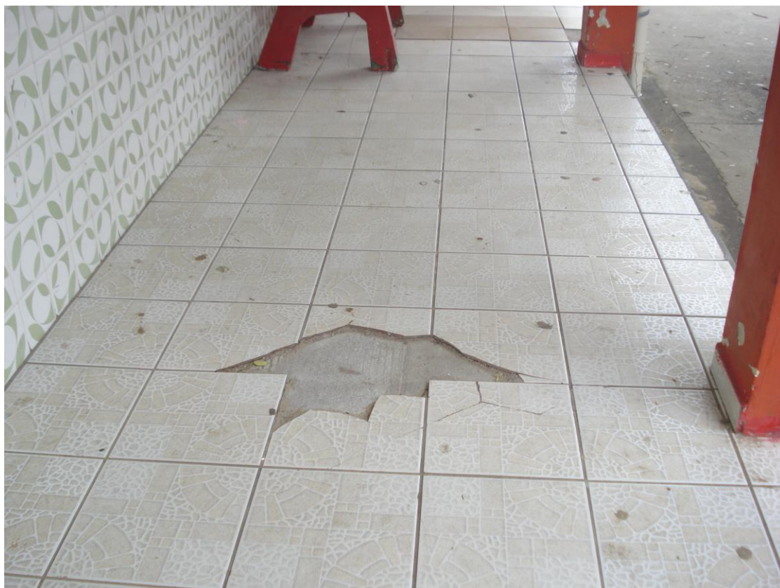
Pisos quebrados nas calçadas.
