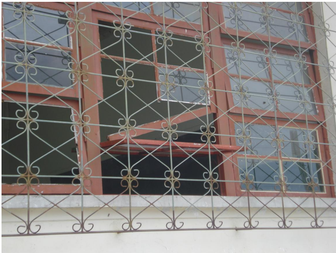
Muitas janelas quebradas e caindo.
