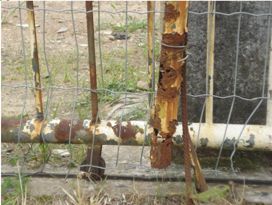
Más condições do portão de estacionamento.
