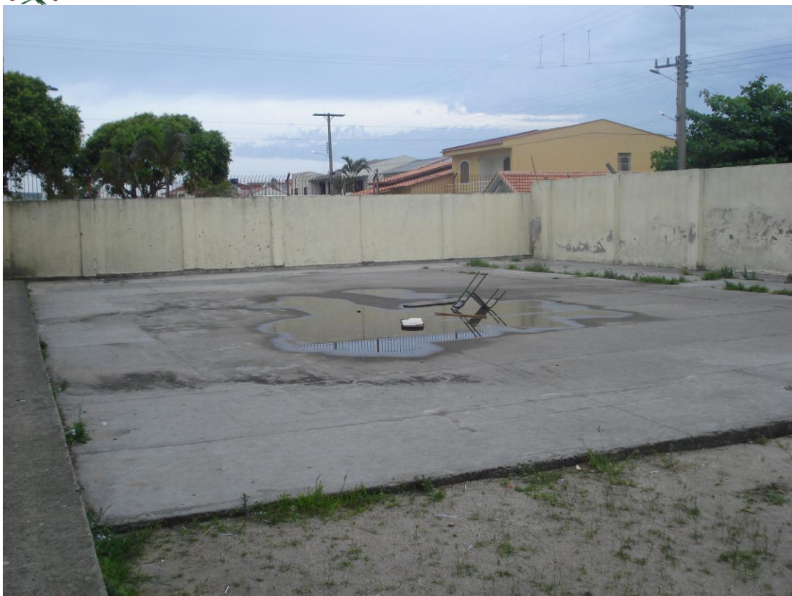
Falta de escoamento em uma das duas quadras de esportes
