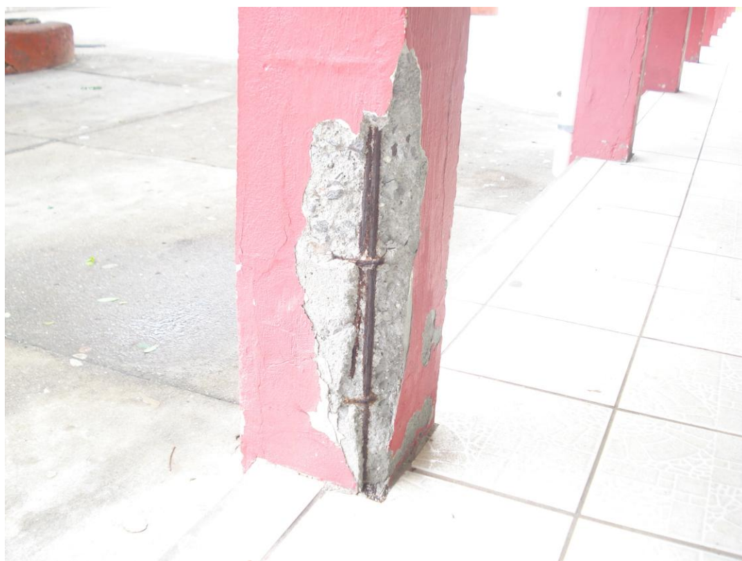
Ferros das vigas de sustentação a mostra.
