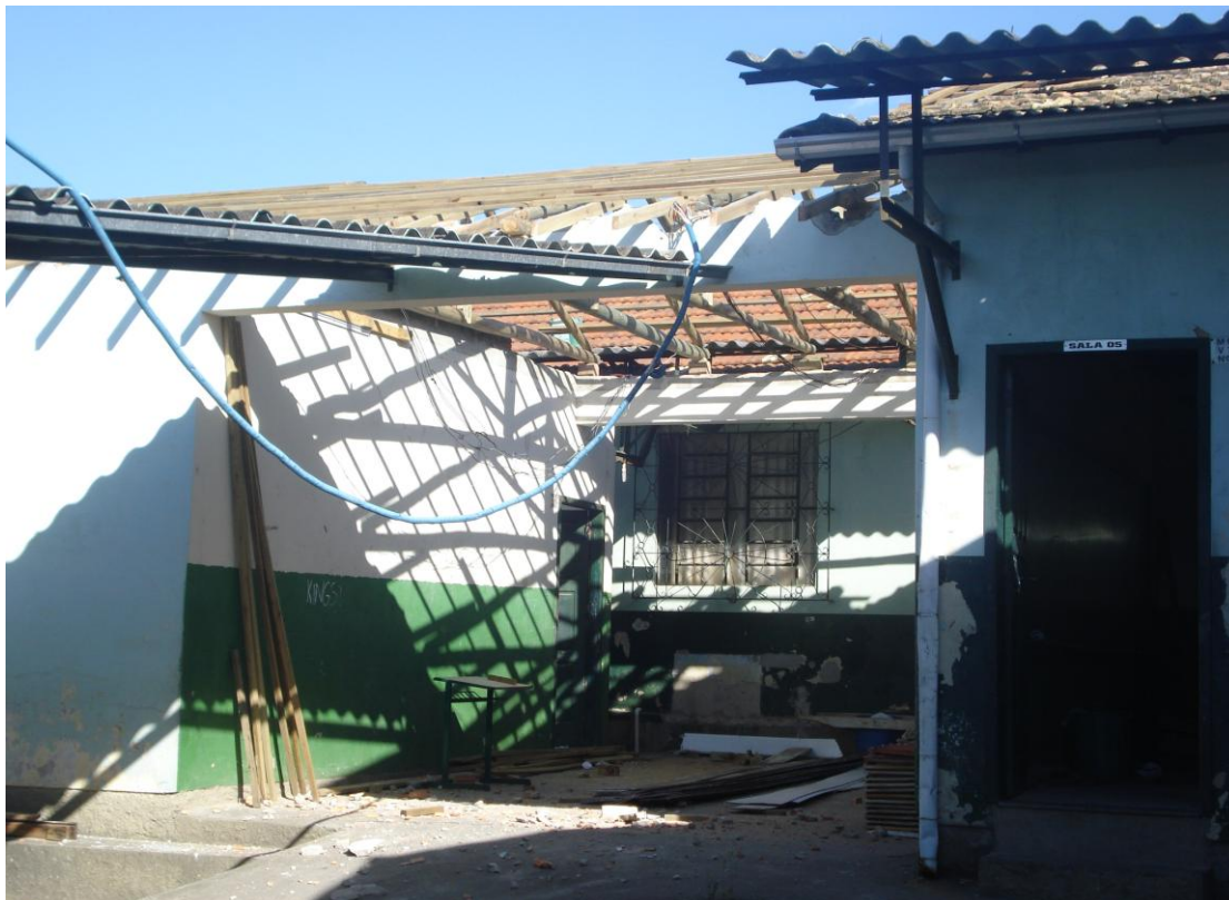
Telhado de parte da estrutura desabou
