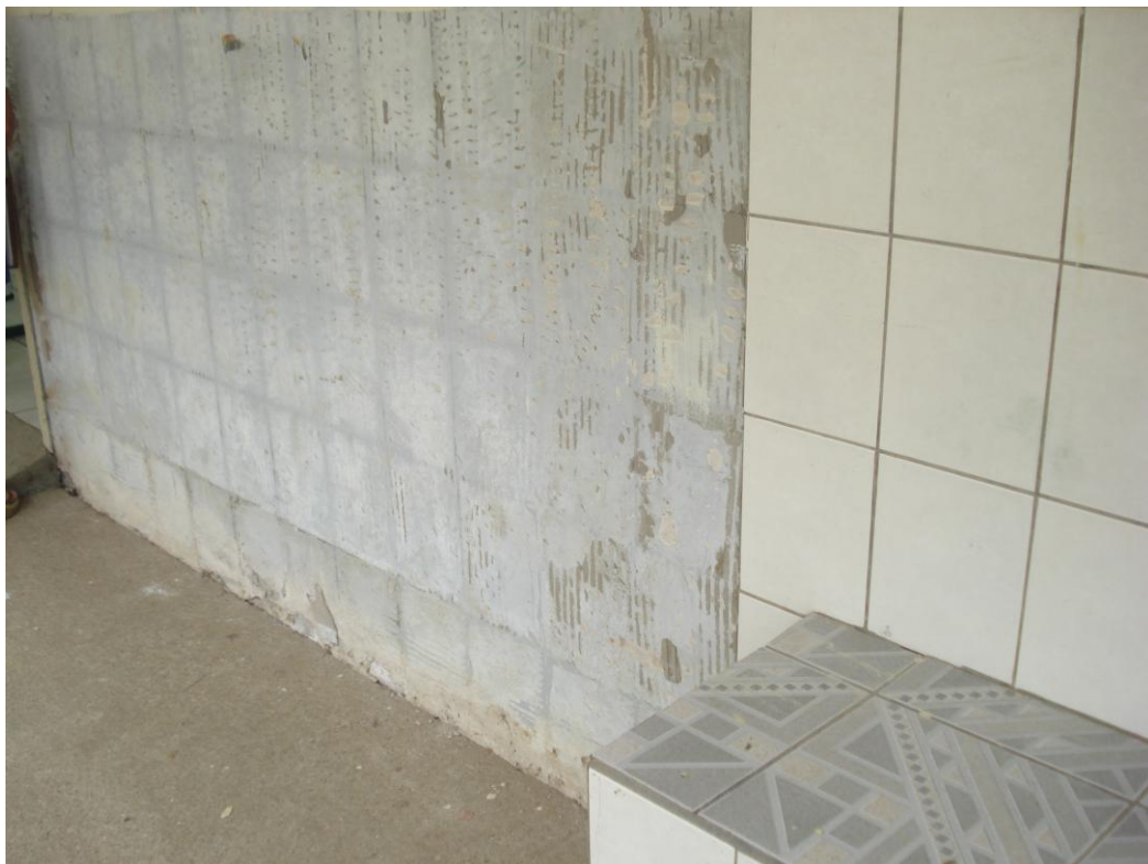
Ladrilhos das paredes caindo.
