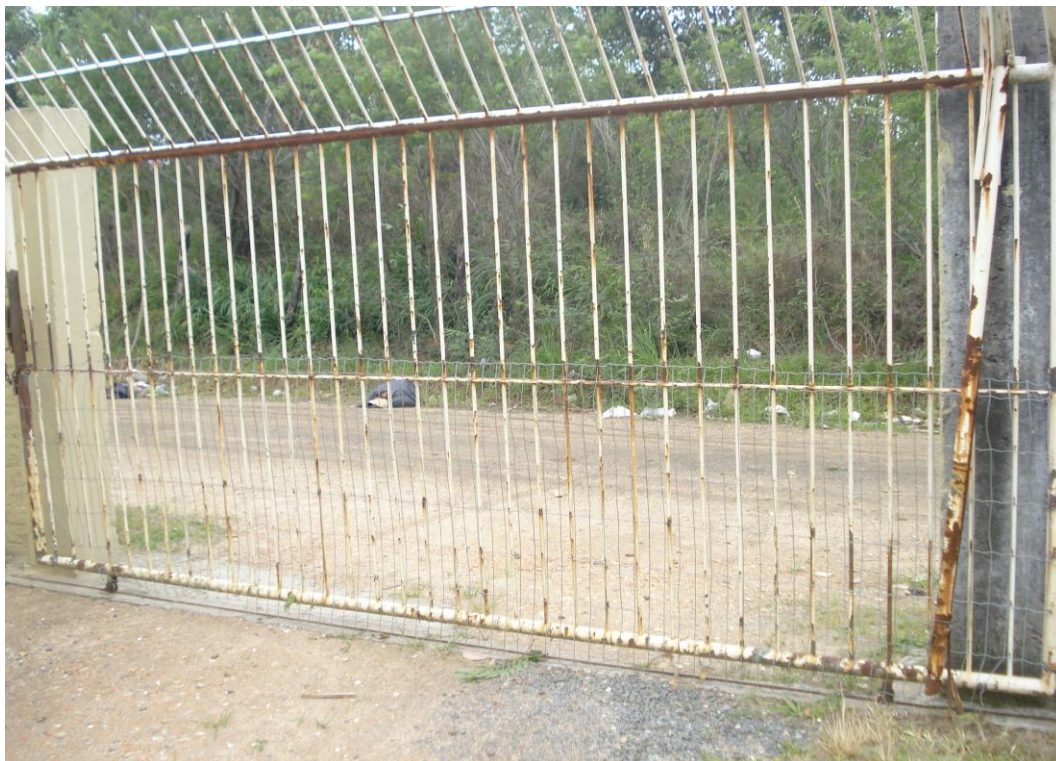
Portão do estacionamento quase caindo.
