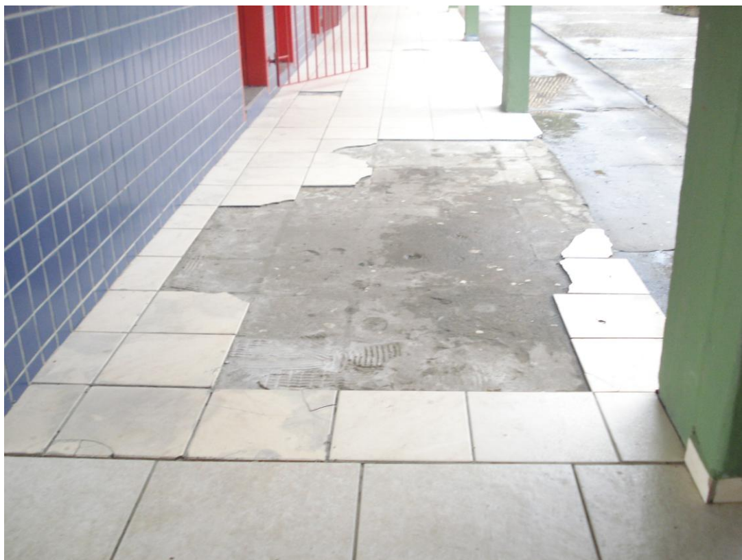
Pisos cerâmicos quebrando.
