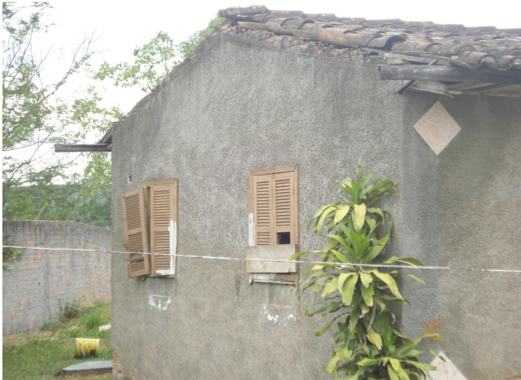
Antiga casa do servente, que atualmente serve de depósito, mas que se encontra em vias de desabamento, necessitando ser demolida.
