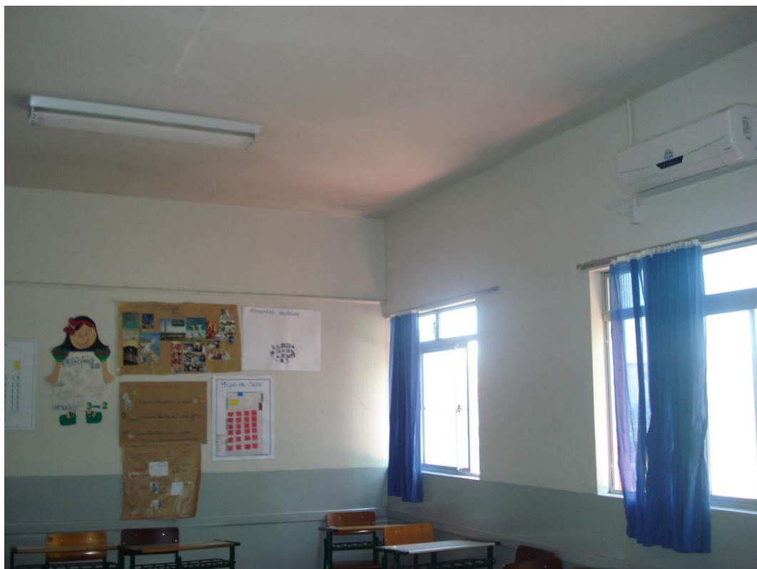
Climatizadores não funcionam porque não há condições na rede elétrica
