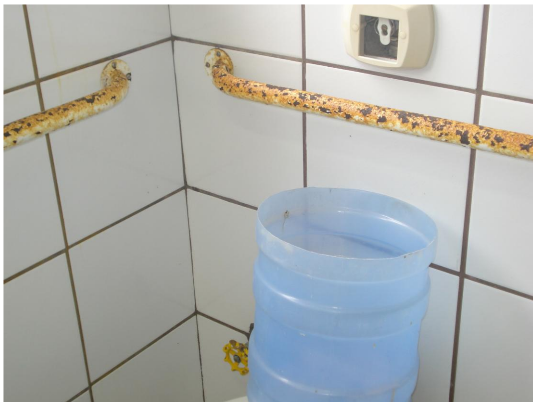
Barra de apoio no banheiro adaptado do ginásio de esportes enferrujada.
