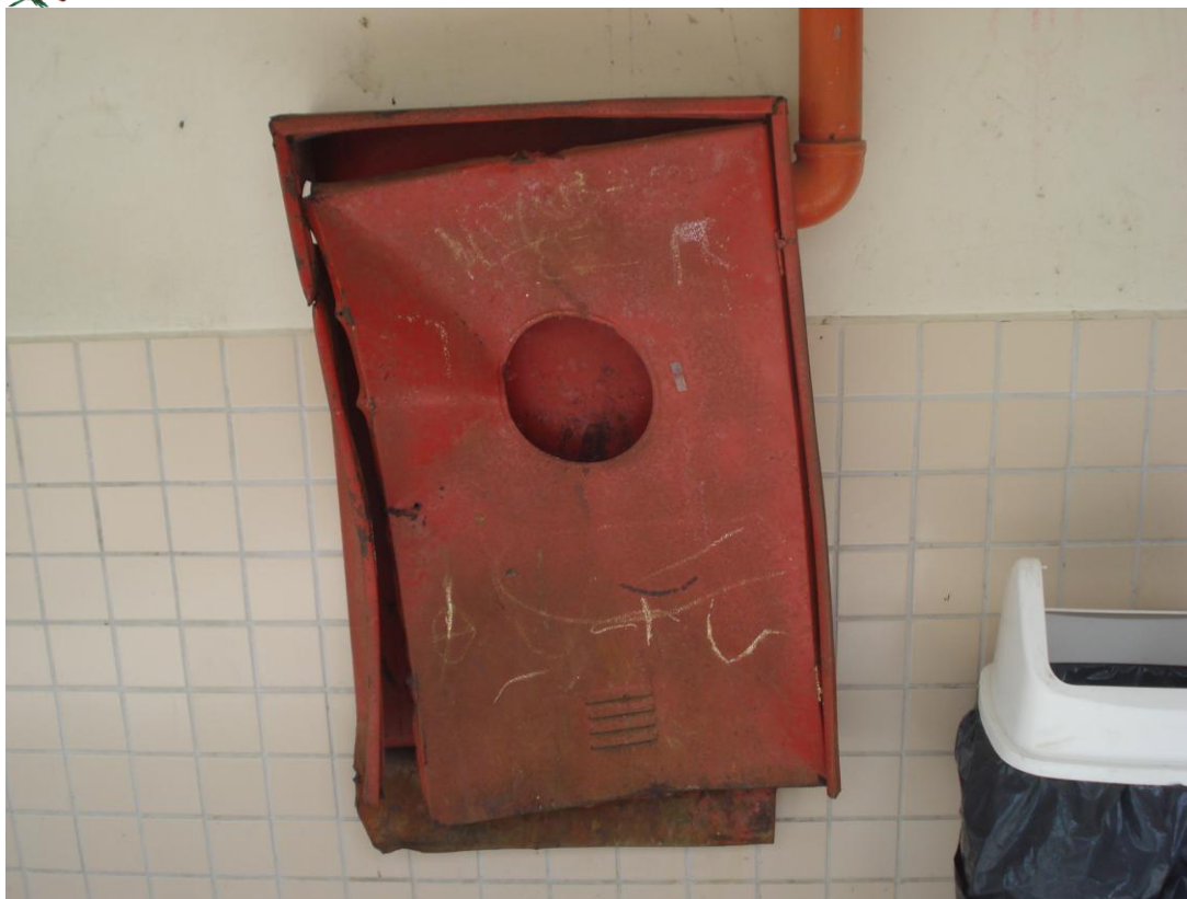
Condições do hidrante que se encontra sem mangueira
