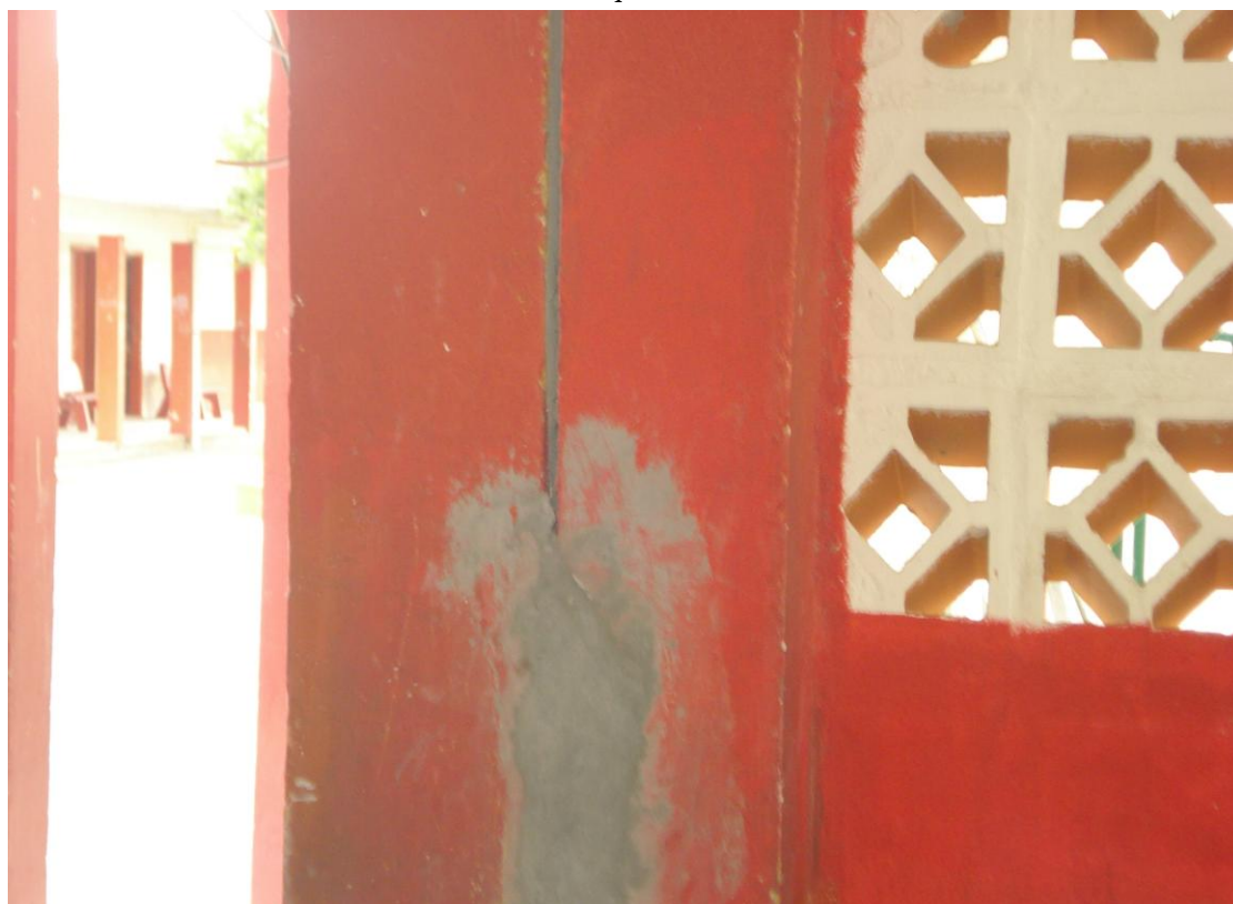
Rachaduras nas paredes.
