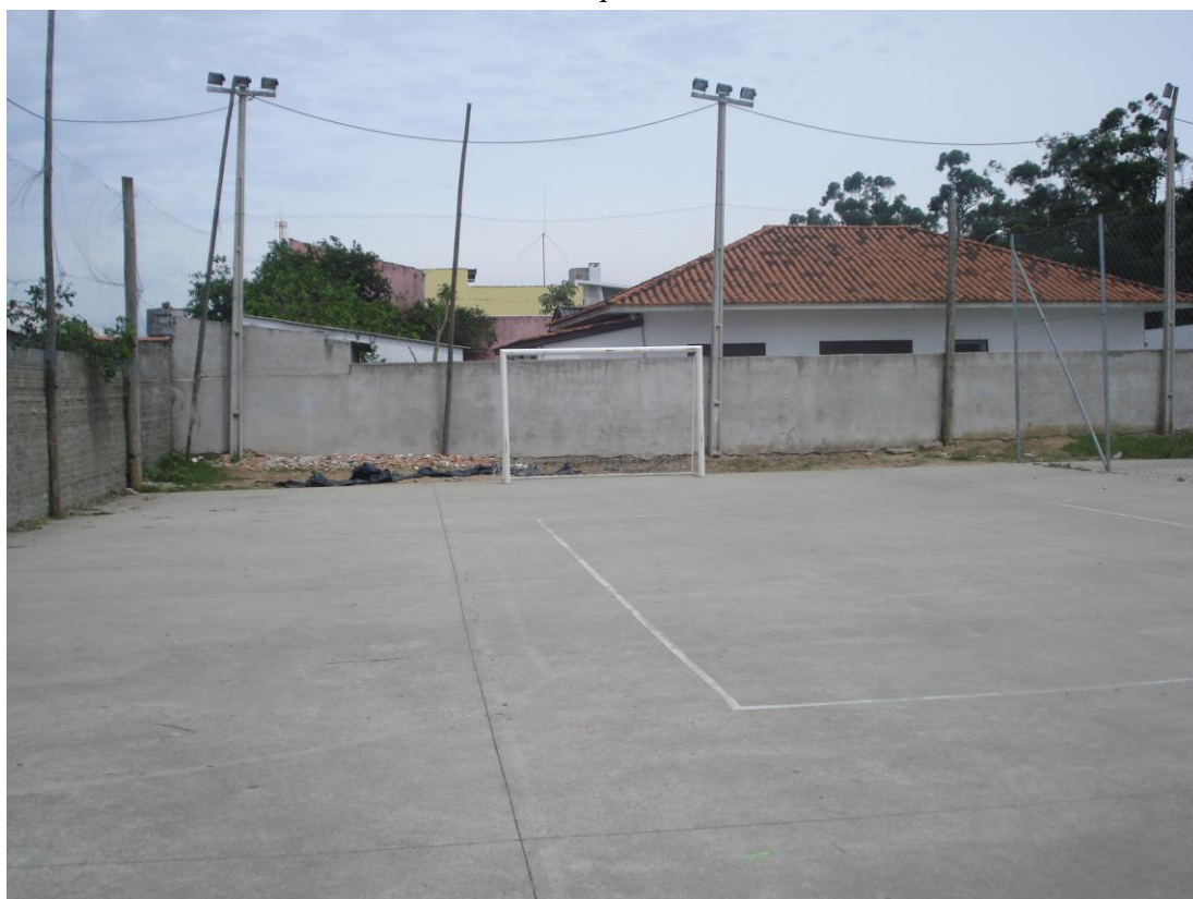
Muros baixos e falta de rede na parte superior permitem que as bolas caiam na rua ao lado da escola
