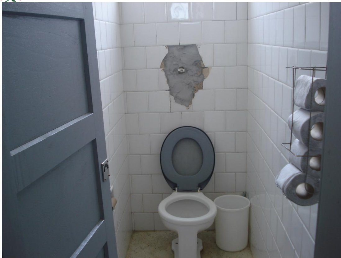
Banheiro com problemas hidráulicos.
