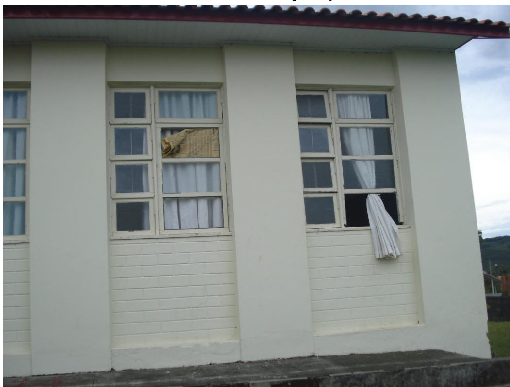
Janelas quebradas e sem recursos para manutenção.
