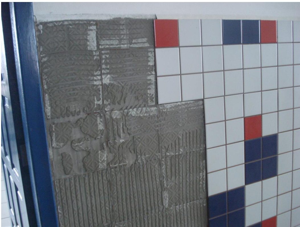
Ladrilho dos corredores caindo.
