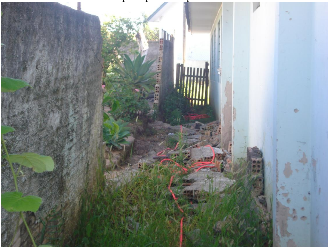
Muro lateral desabou
