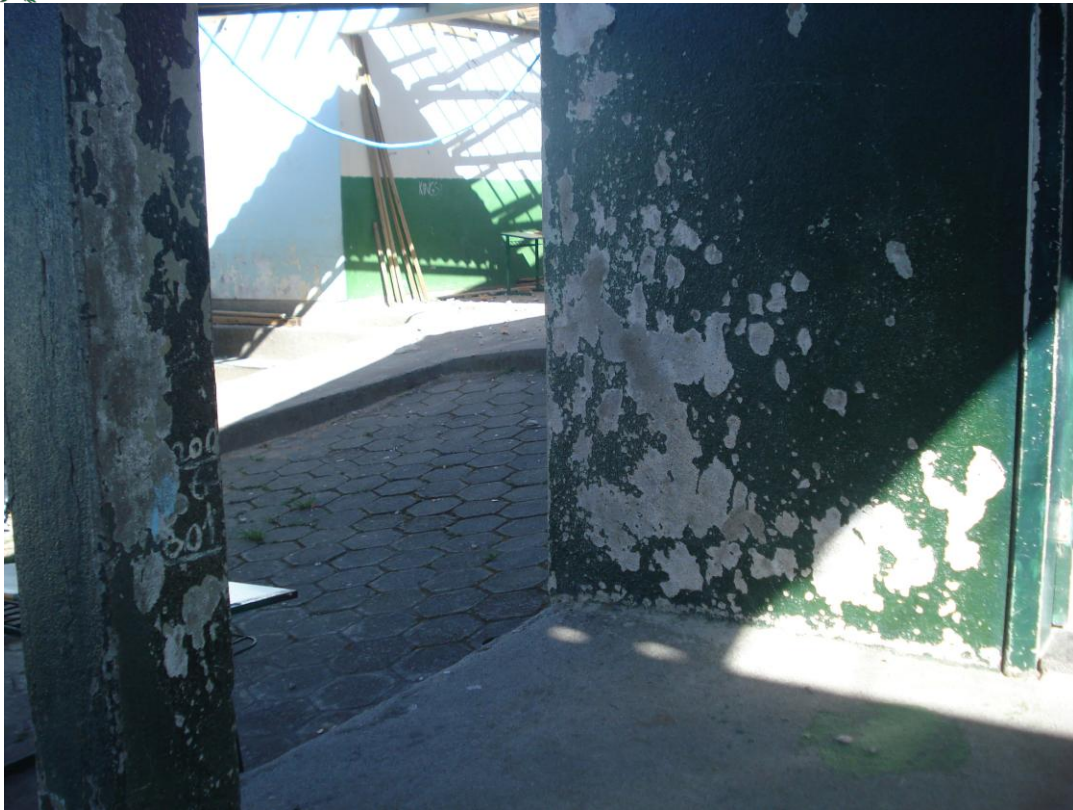
Pinturas em péssimas condições
