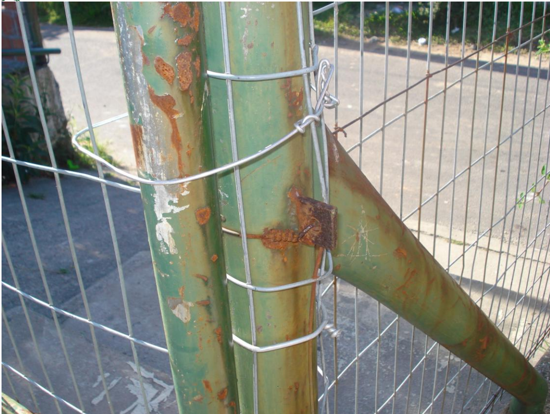
Portão preso por arame para não cair
