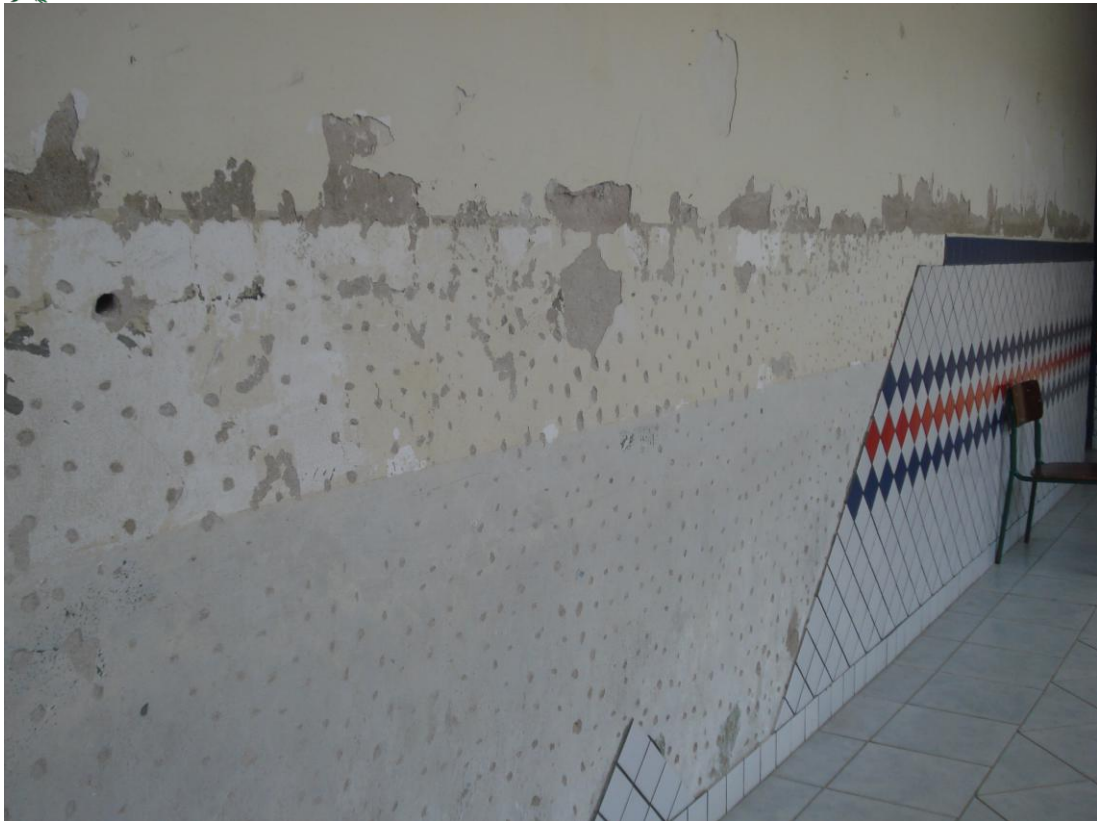
Ladrilhos do corredor caindo.
