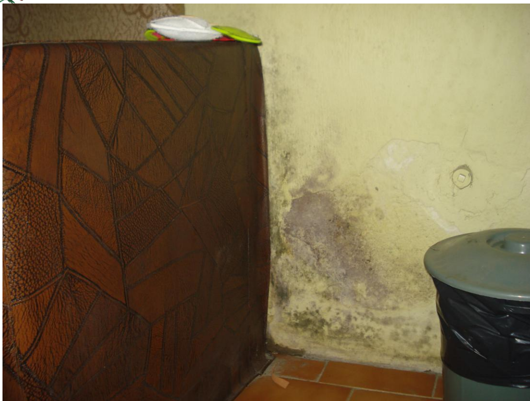
Infiltrações nas paredes
