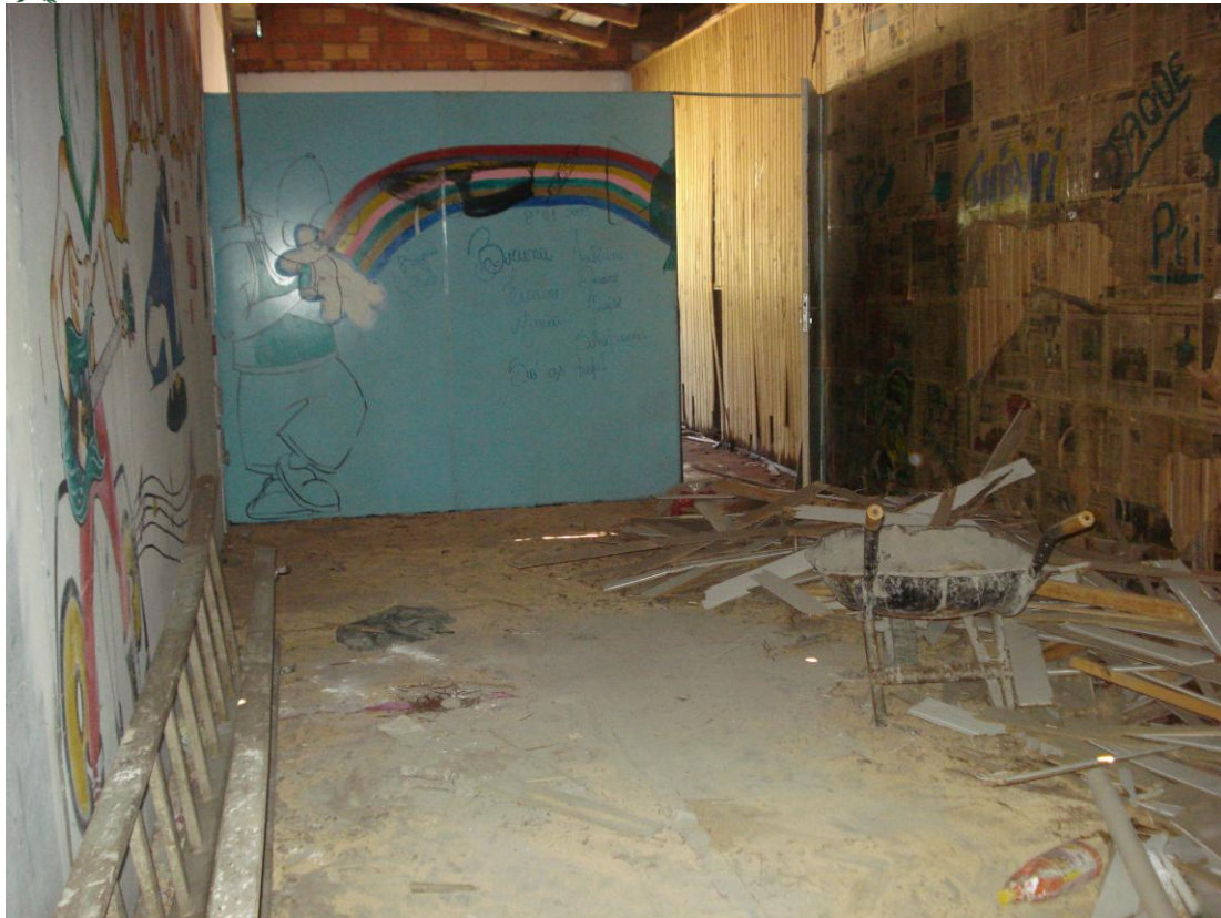
Sala de depósito foi desmanchada porque estava em vias de desabamento
