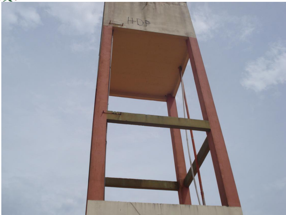
Falta de acesso à caixa d'água
