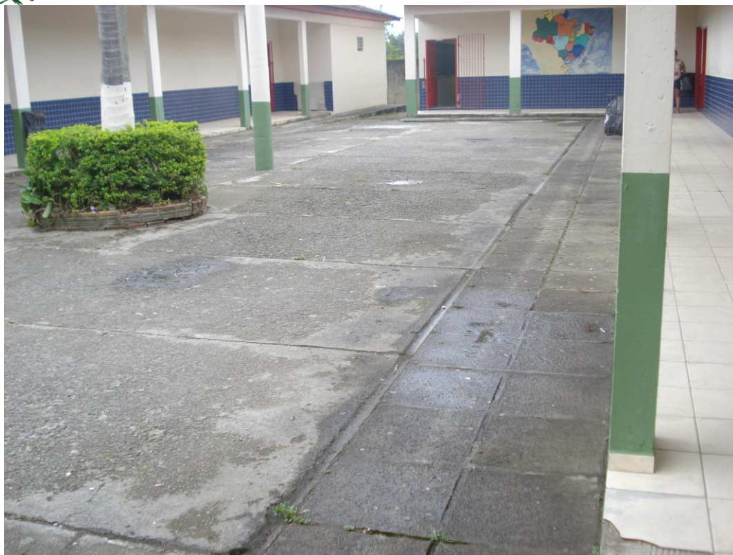
Área descoberta alaga em dias de chuva devido à falta de drenagem.
