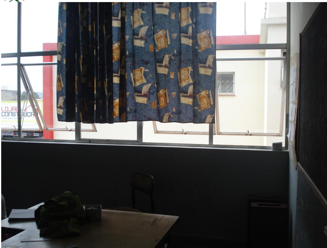
Faltam cortinas adequadas nas janelas.
