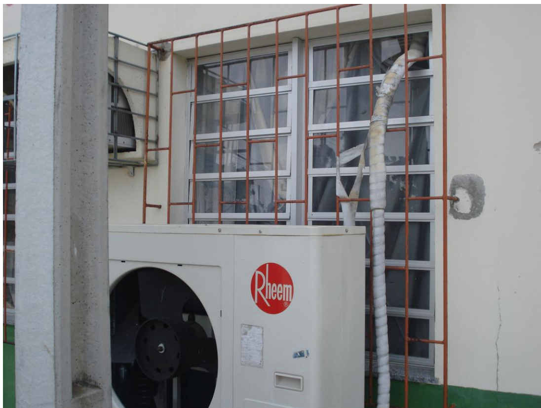
Instalação mal feita no cabeamento do climatizador da sala informatizada
