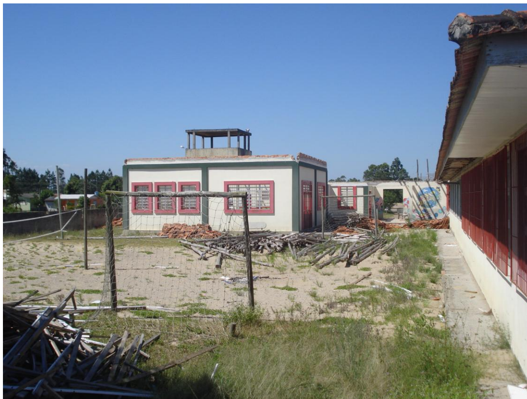
No início do ano de 2012 houve o desabamento do teto do prédio escolar
