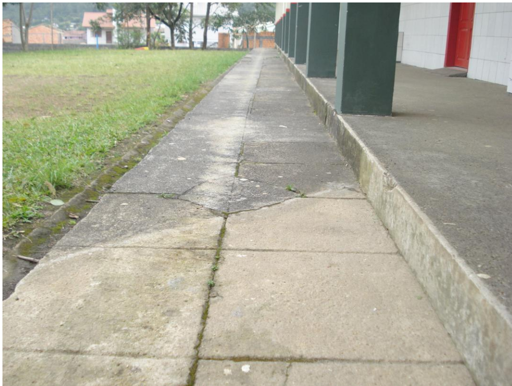
Calçadas necessitando de piso cerâmico.
