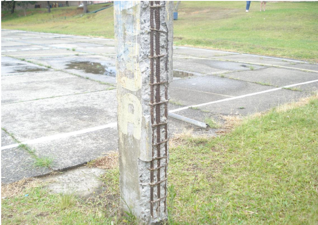
Condições da viga de sustentação da cesta de basquete.
