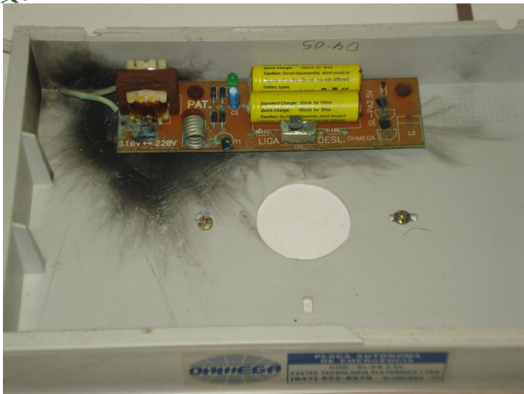
Curto-circuito na rede elétrica.
