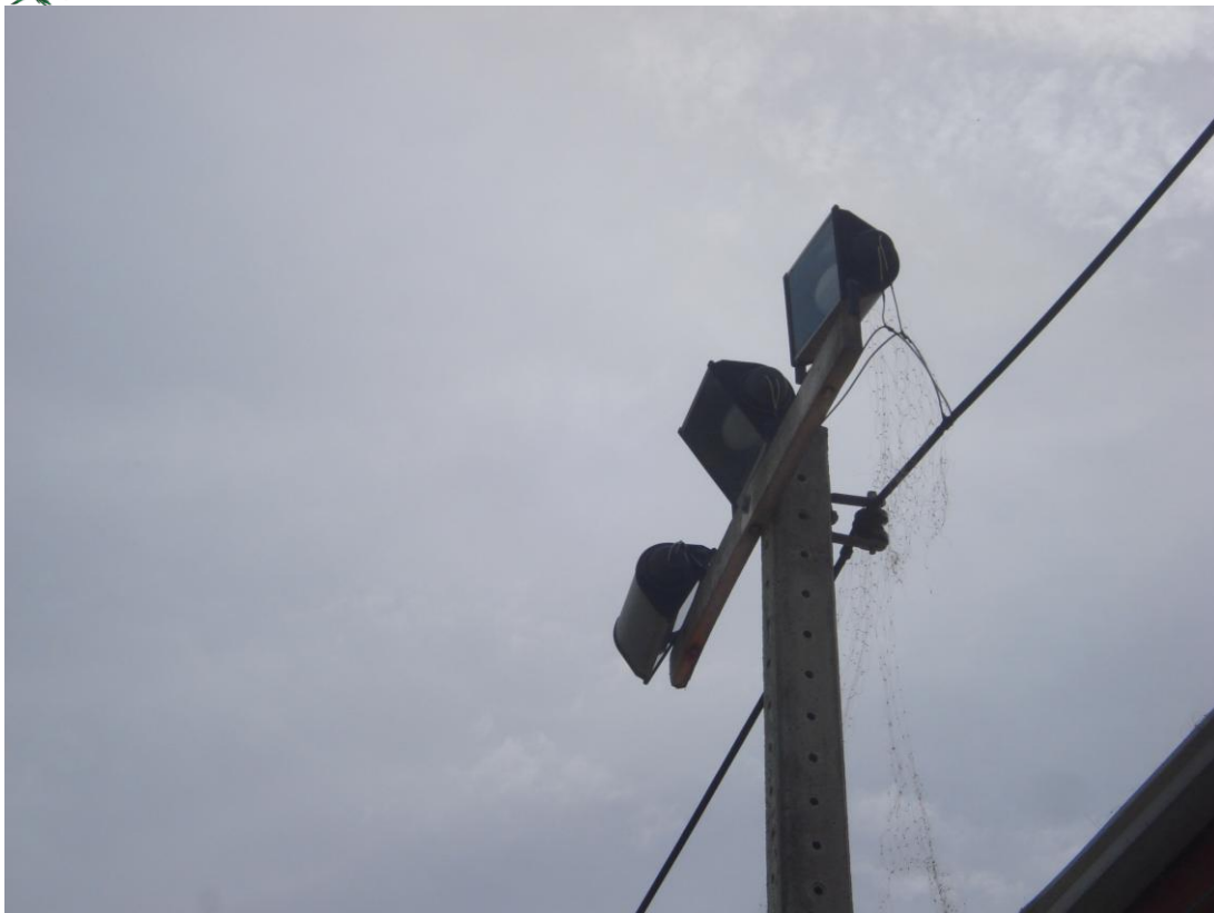
Problemas nos refletores da quadra de esportes
