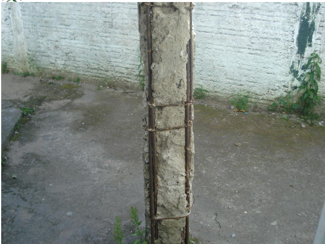
Vigas de sustentação em péssimas condições
