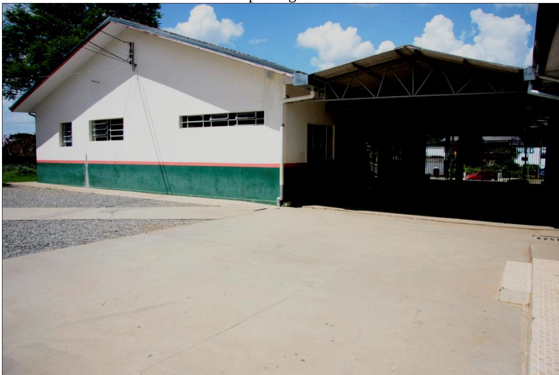
Parte administrativa com sérios problemas no telhado, causando muitas goteiras que molham a documentação da escola
