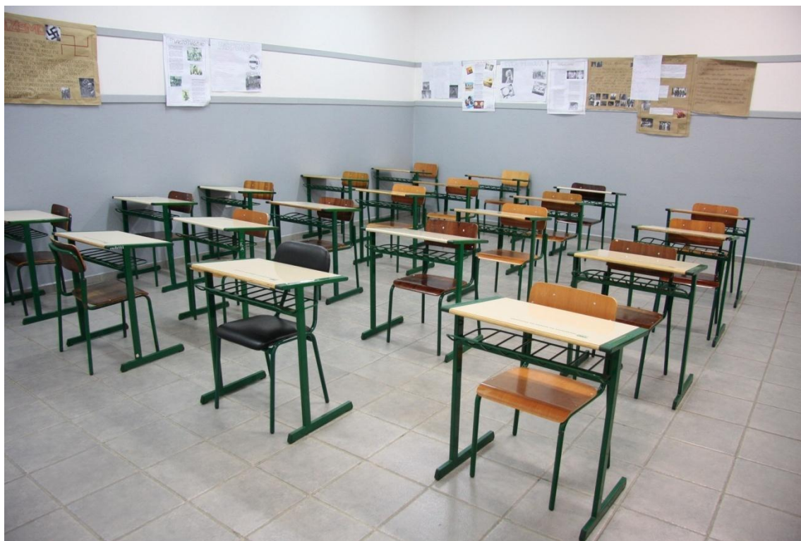
Salas de aula em boas condições, porém abafadas
