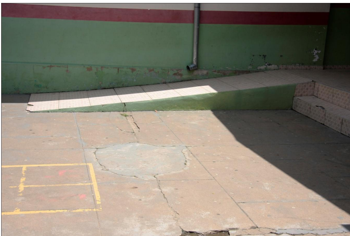
Condições do piso da quadra descoberta
