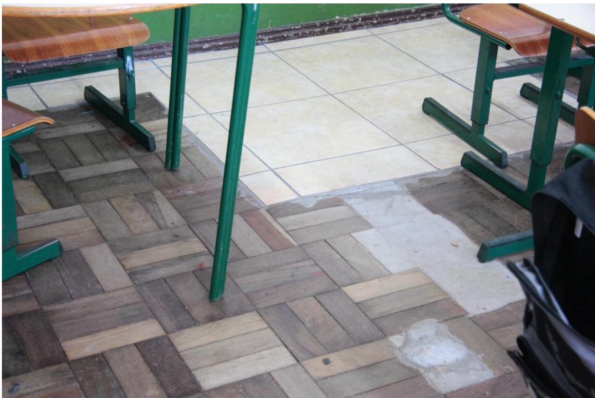
Tacos soltando nas salas de aula
