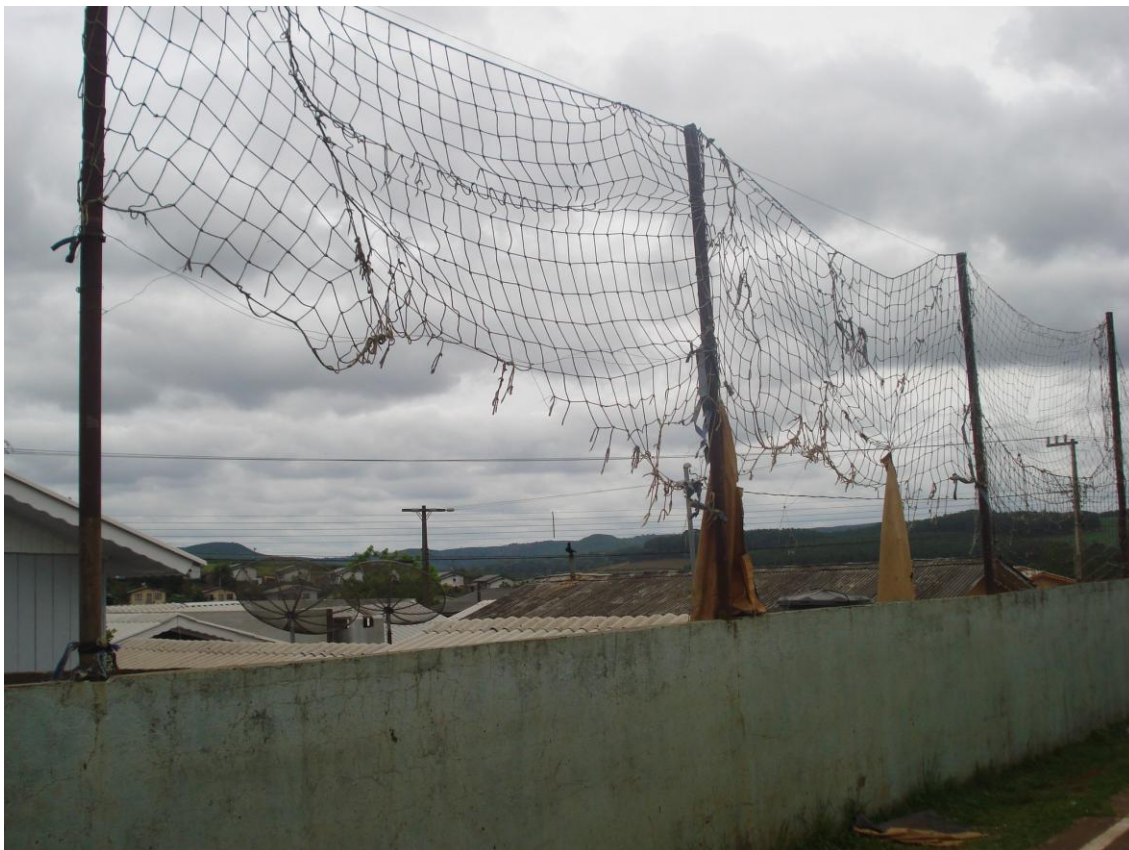
Redes de proteção rasgadas
