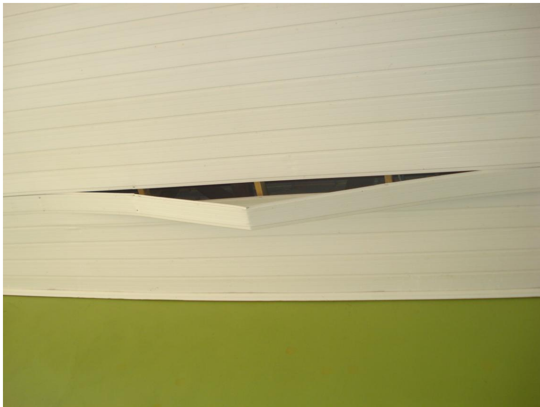
Forro de PVC caindo
