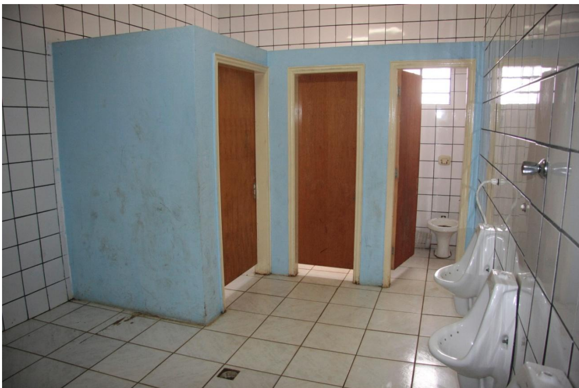
Banheiros com problemas hidráulicos, apenas um em funcionamento
