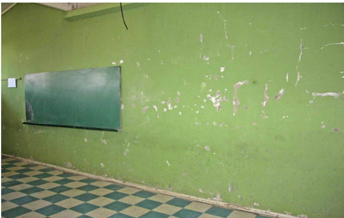
Necessidade de pintura em toda a escola
