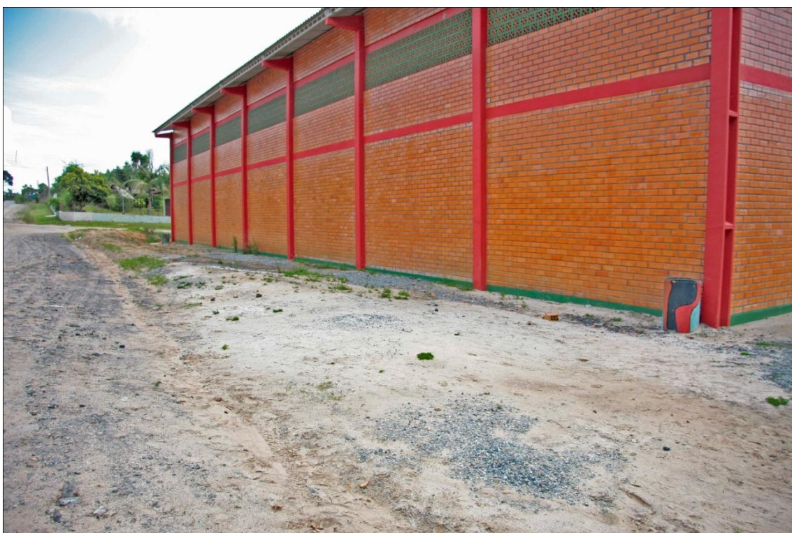
Faltam muros em volta da quadra coberta
