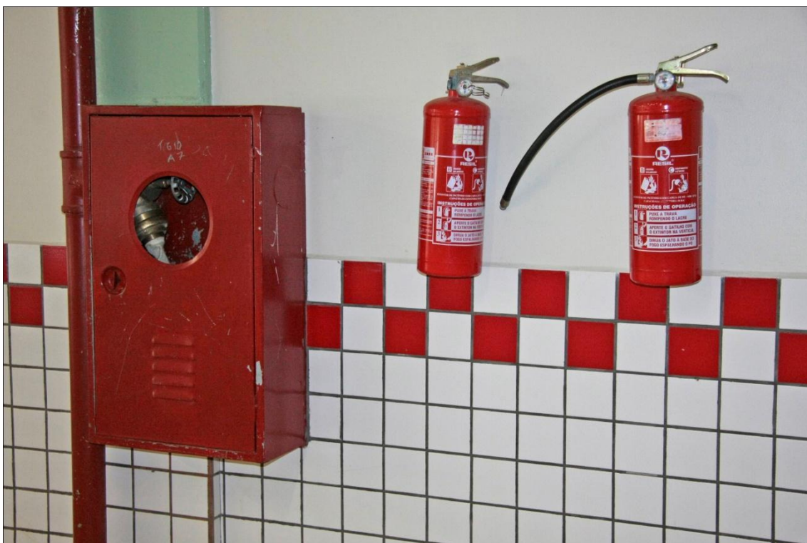
A escola possui hidrantes e extintores para combate a incêndio.
