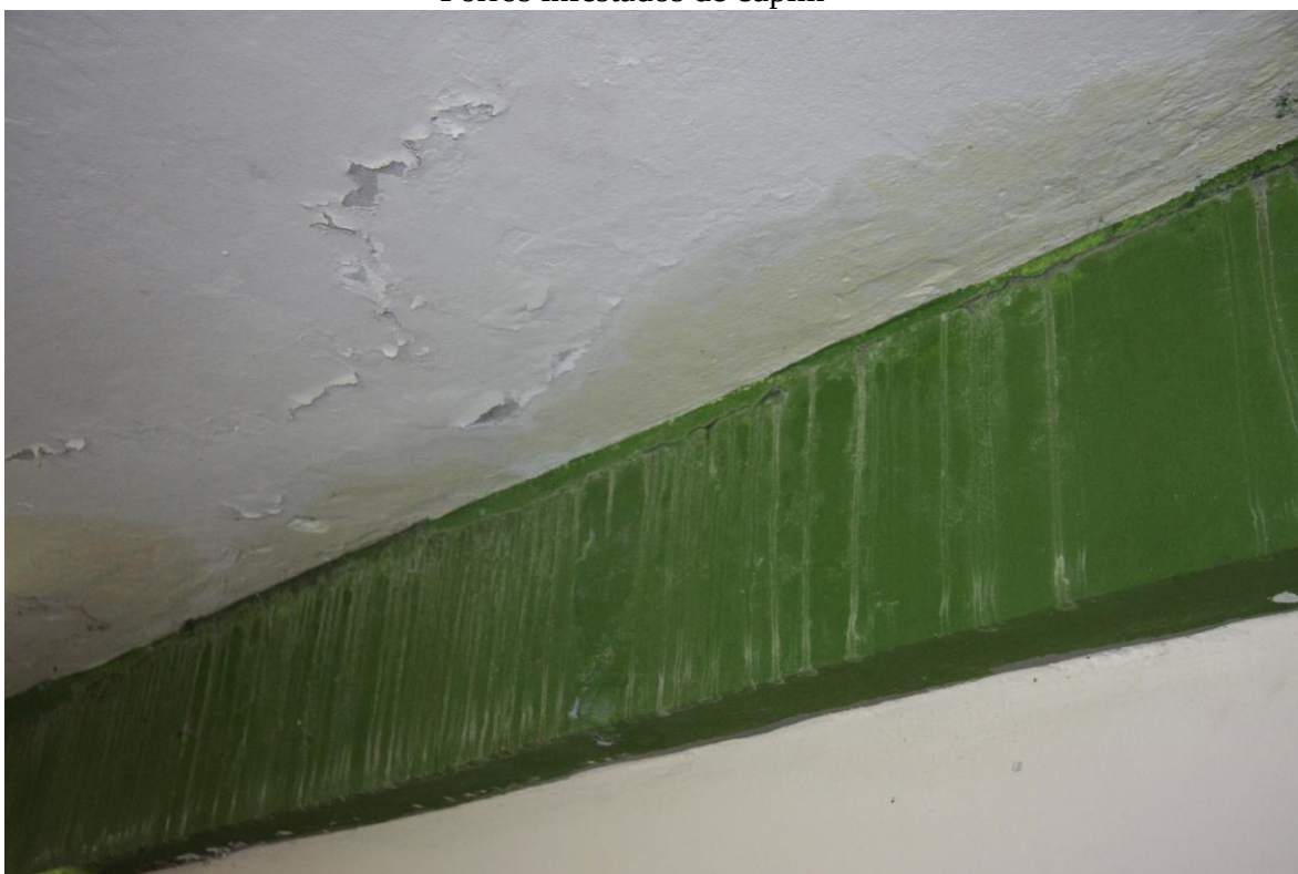
Infiltrações no teto
