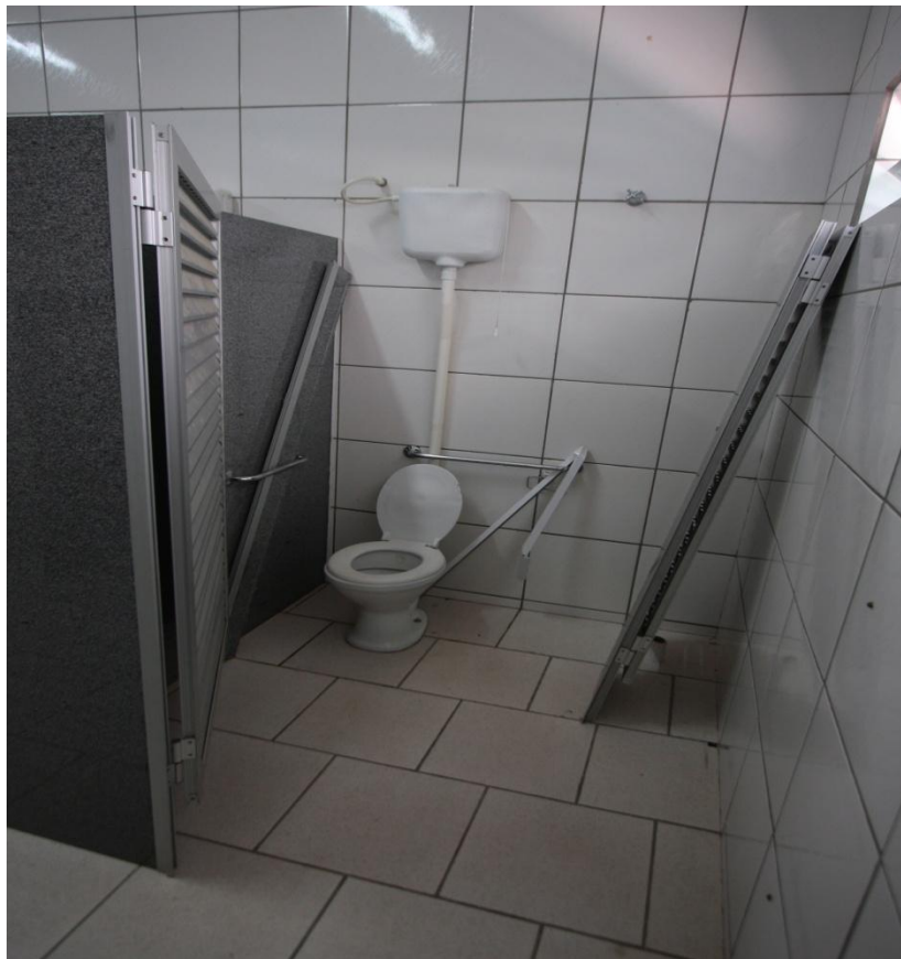
Necessidade de acabamento no banheiro adaptado
