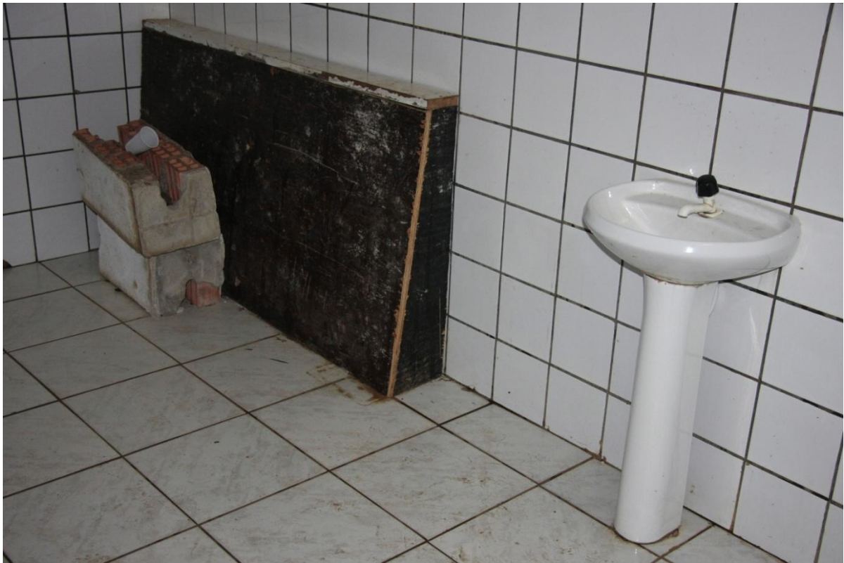
Banheiros necessitando de manutenção
