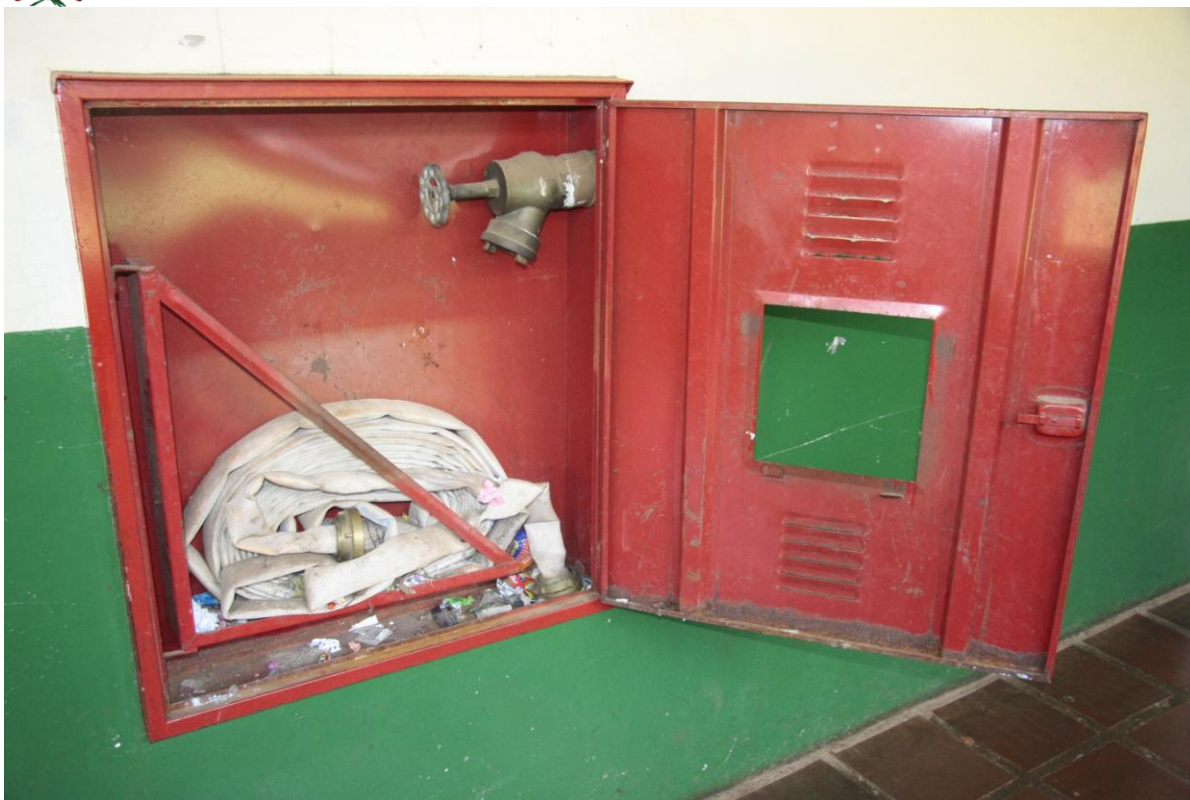
Hidrantes em péssimas condições
