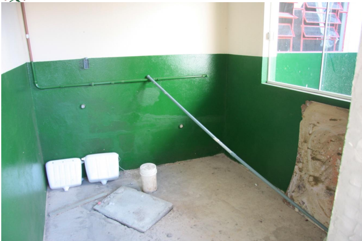
Falta de acabamento da última reforma
