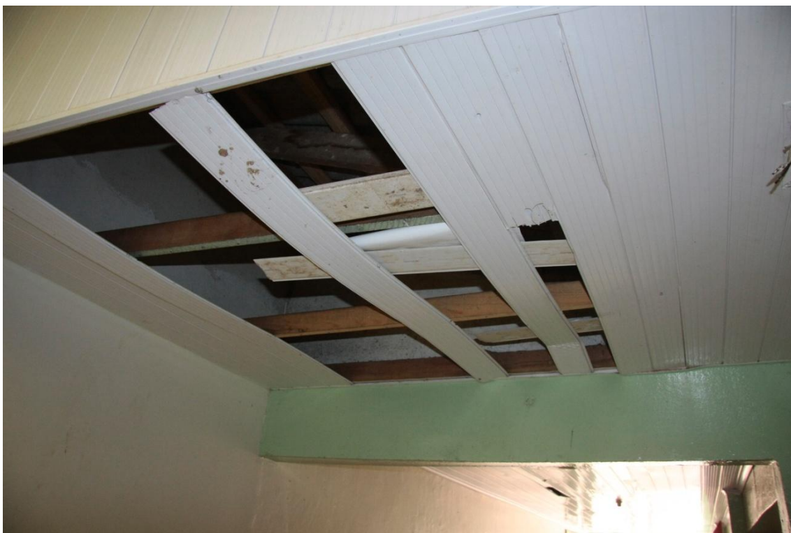
Forro de PVC destruído
