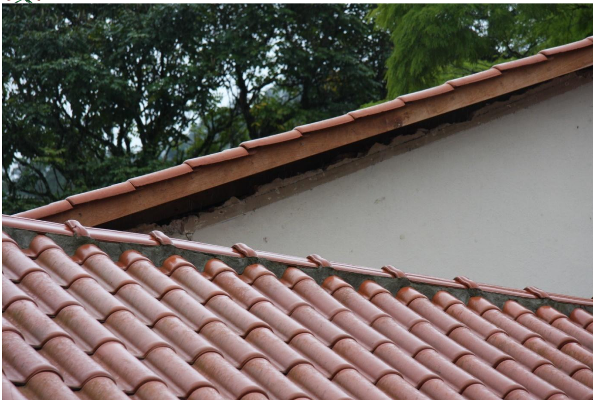
Falta de acabamento no telhado permite a entrada de animais
