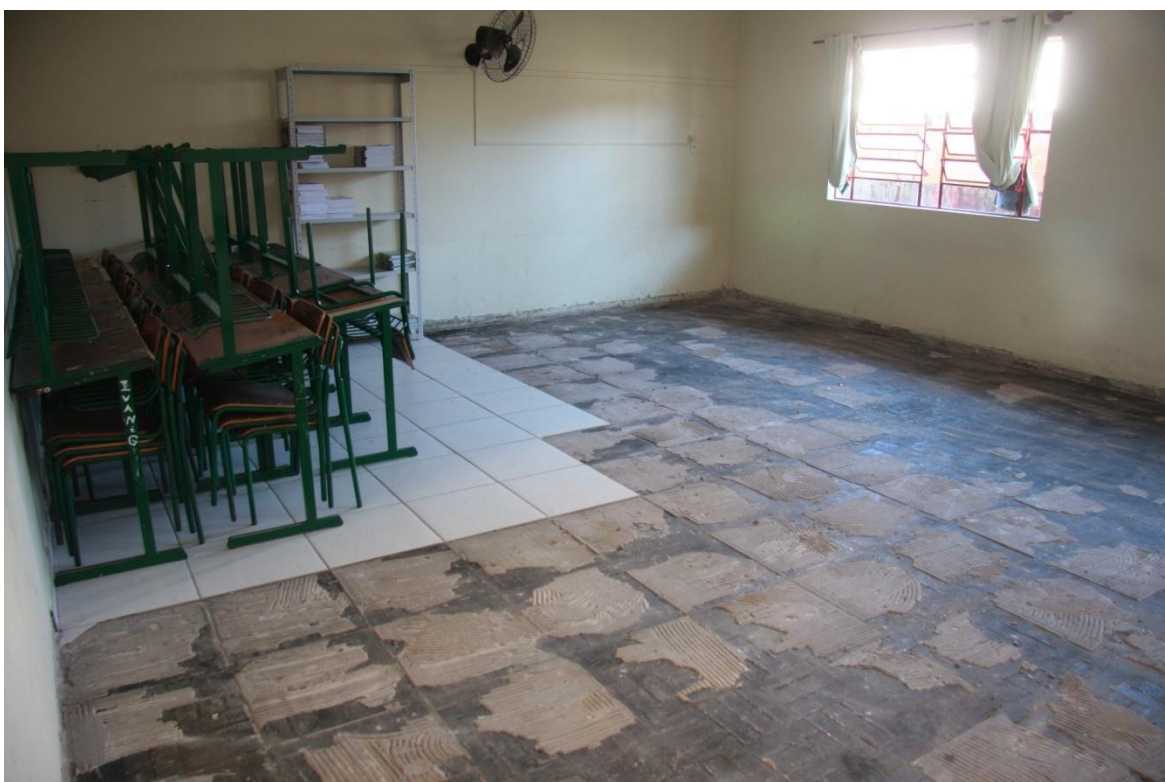
Piso soltando um ano após a reforma
