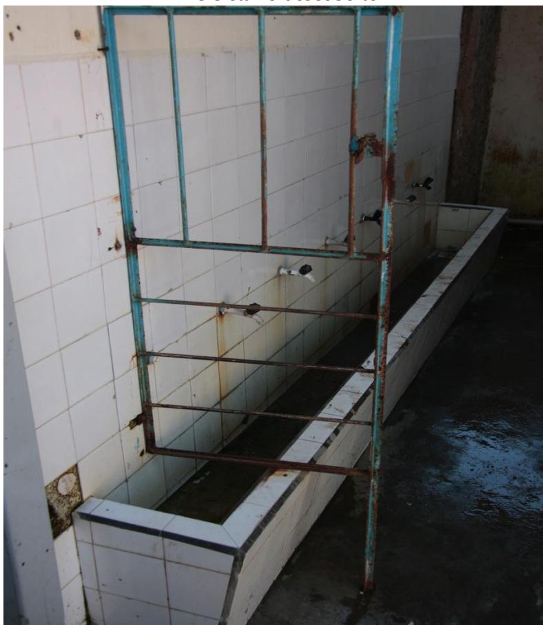
Bebedouro em situação precária
