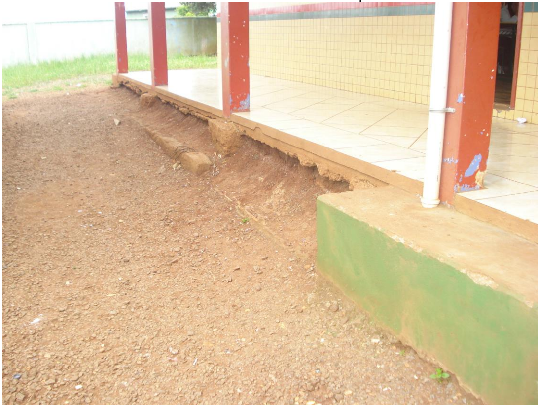
Calçada feita no ano de 2006 está desabando
