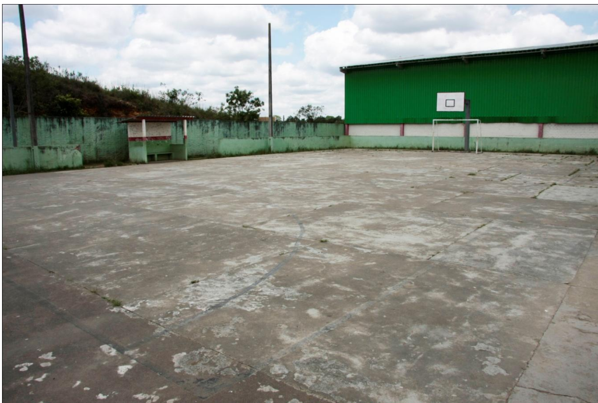
Quadra descoberta necessitando de manutenção
