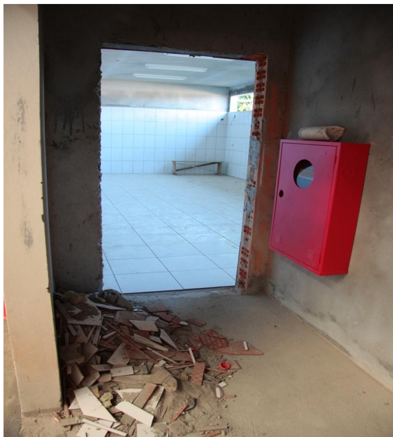
A reforma iniciada no ginásio não foi concluída
