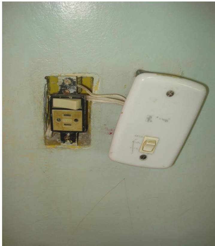
Fiação elétrica exposta
