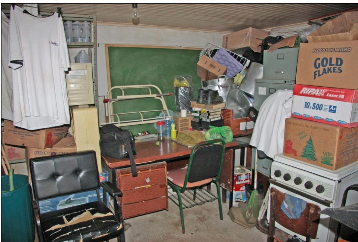
Porão que serve de depósito para materiais com muito mofo
