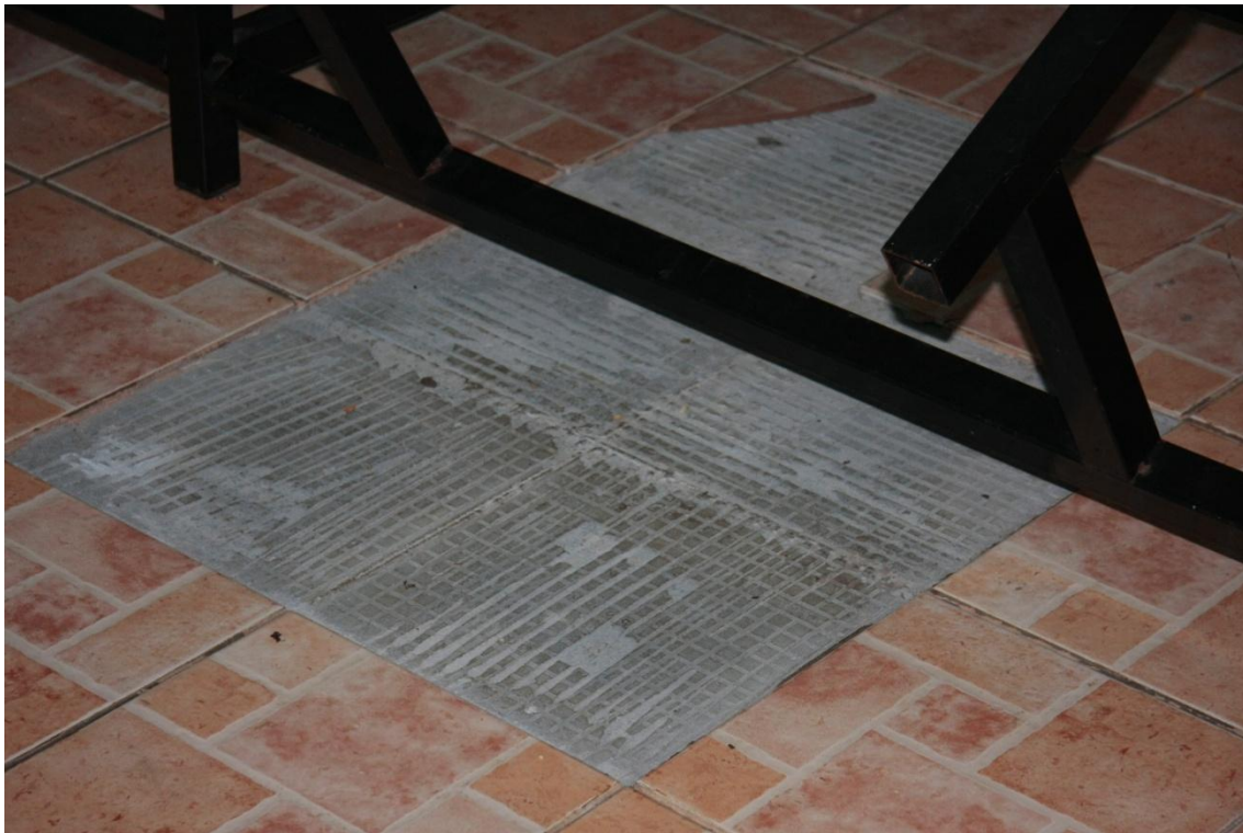
Pisos soltando na cozinha
