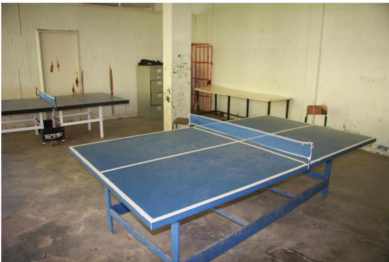
Sala de educação física necessitando de manutenção
