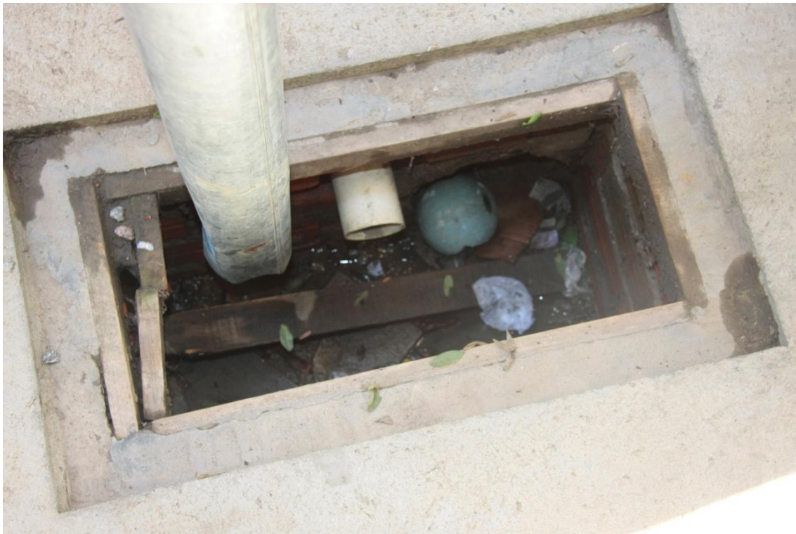
Falta de tampa na vala de escoamento que se localiza no refeitório
