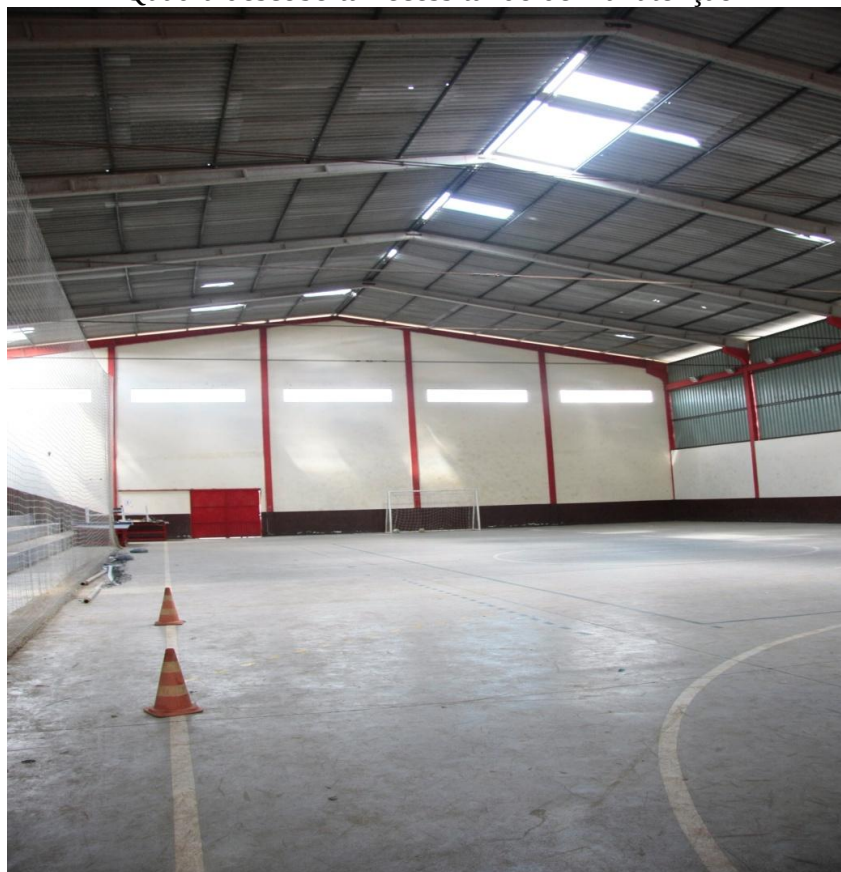
Ginásio de esportes com telhado arrancado por um vendaval e sem manutenção devido à falta de servidores para fazer a limpeza
