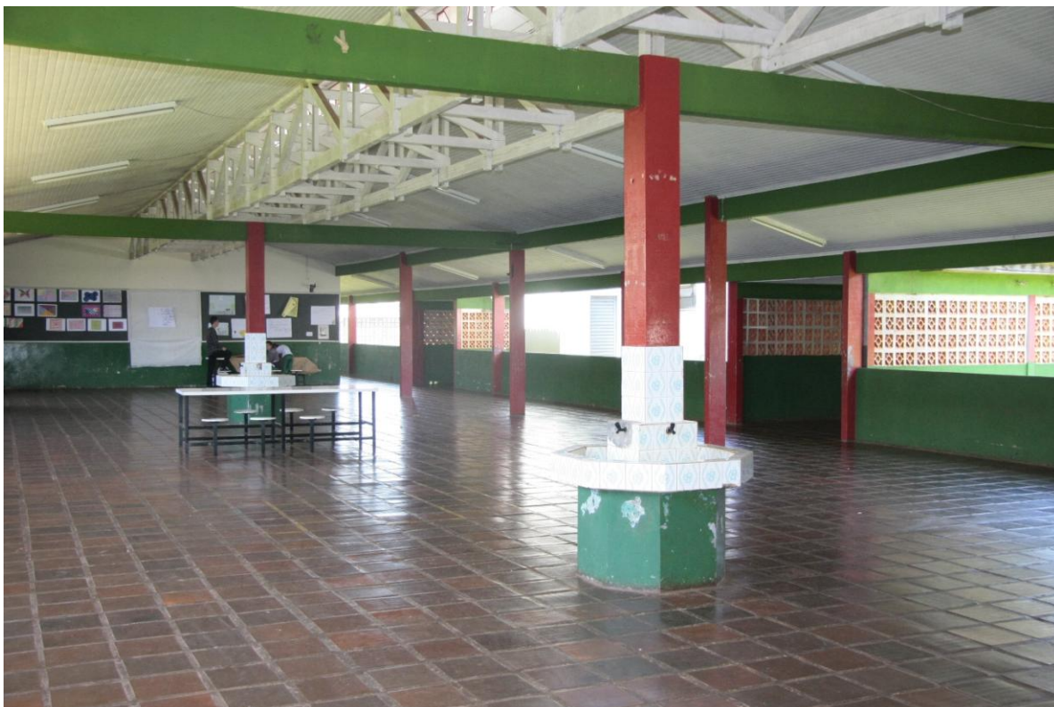
Área coberta, onde os alunos fazem o recreio, alaga nos dias de chuva por causa da falta de drenagem no solo
