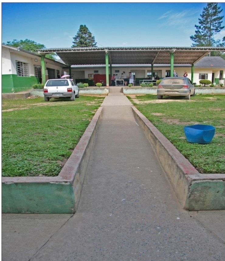
A chuva escorre da ala de cima e, sem escoamento, alaga a ala dos fundos
