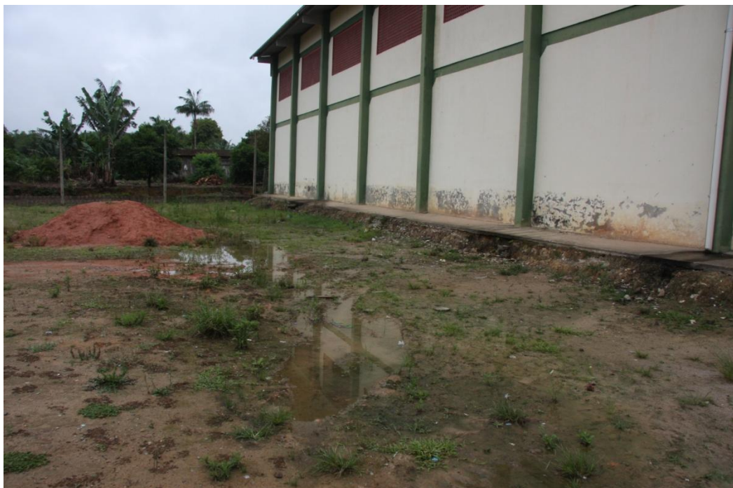
Terreno cedendo próximo ao ginásio e à área coberta
