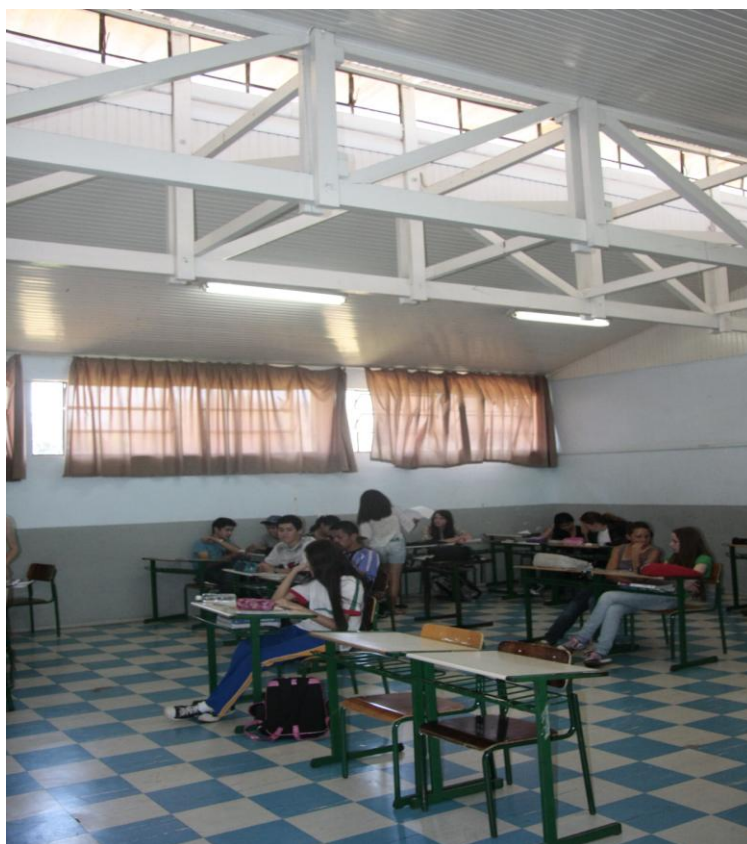
Janelas muito pequenas e altas deixando a sala muito abafada
