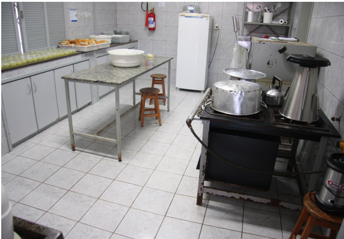
Falta instalar ralo na cozinha, a água tem que ser puxada para o corredor do refeitório
