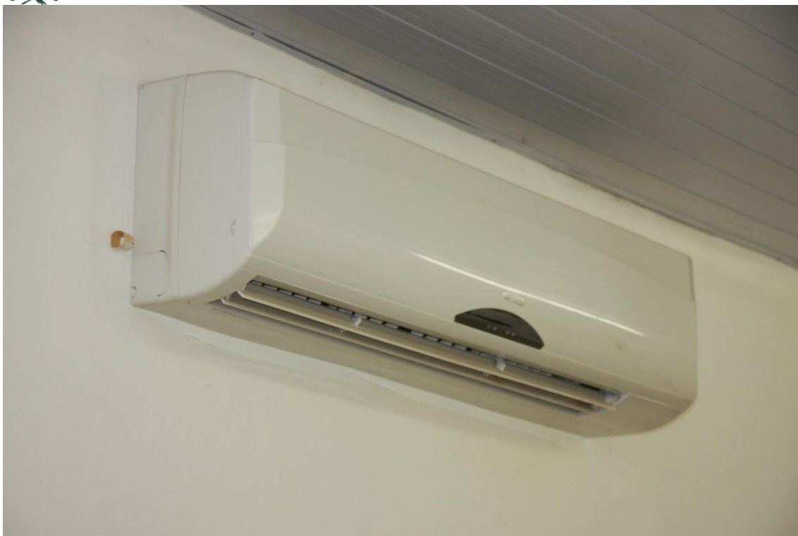
Algumas salas de aula possuem climatizadores, porém não estão ligados por falta de capacidade da instalação elétrica
