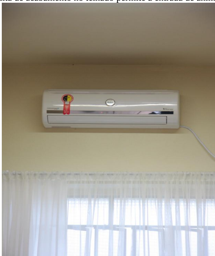
14 climatizadores nas paredes não estão ligados por falta de capacidade elétrica
