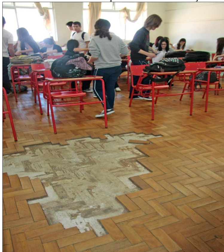
Tacos soltos nas salas de aula
