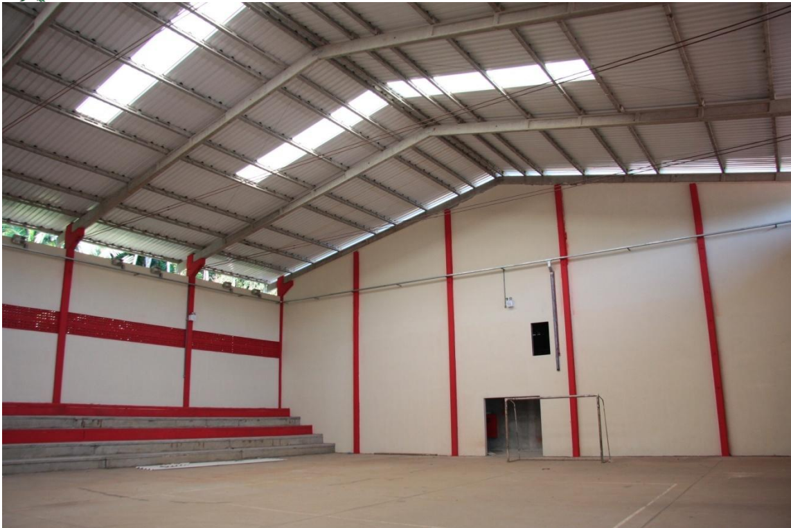
Ginásio de esportes desativado por falta de condições de uso
