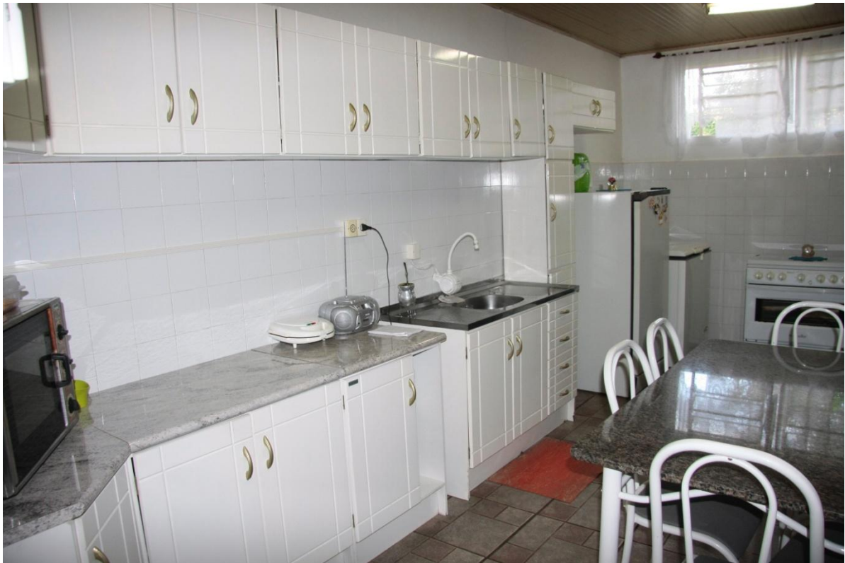
Cozinha dos professores e onde é feita a merenda está com piso cedendo
