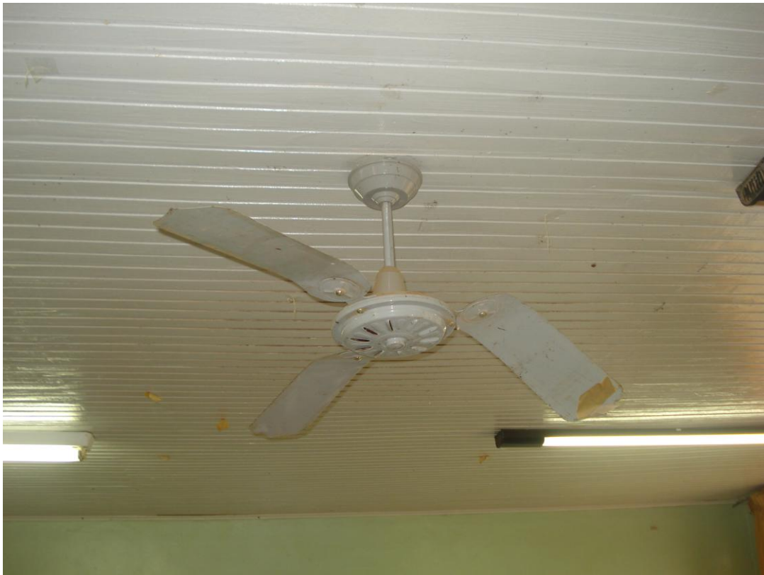
Ventiladores das salas de aula estão quebrados
