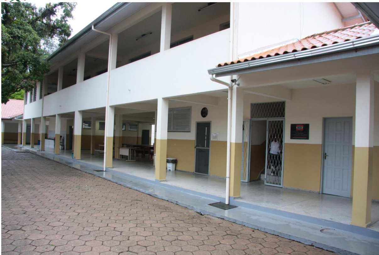
Faltam rampas de acesso ao piso superior
