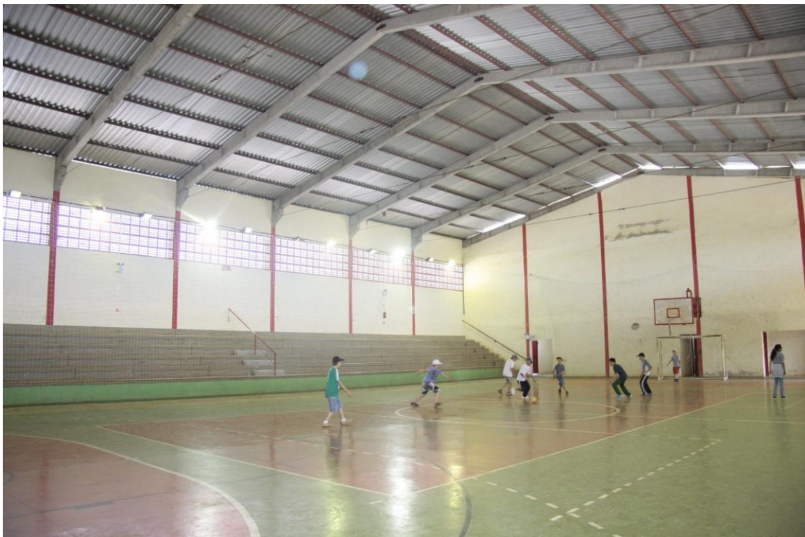
Em dias de chuva não é possível utilizar o ginásio, que fica alagado por causa das goteiras
