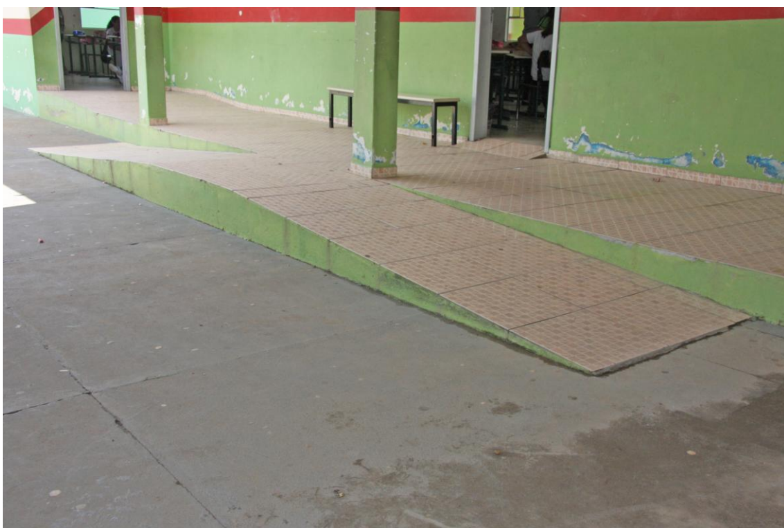
Viga encontra-se no meio da rampa de acesso, impossibilitando a passagem de cadeiras de roda
