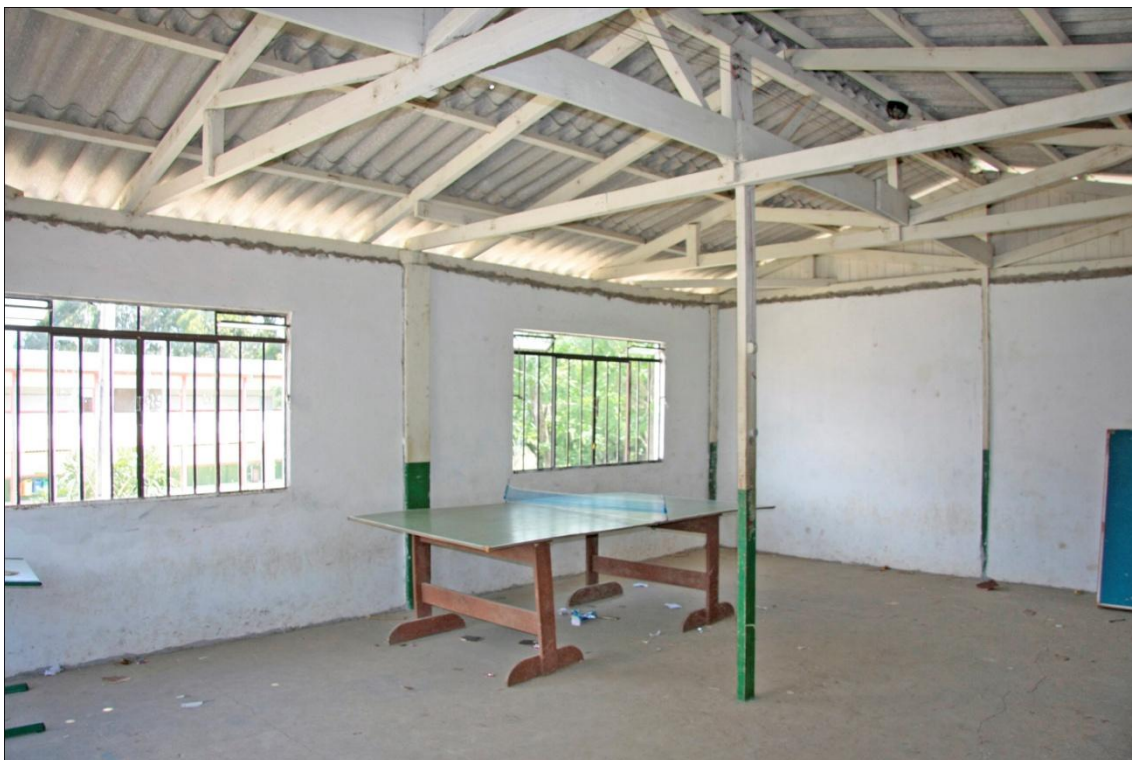
Sala de jogos improvisada e em péssimas condições
