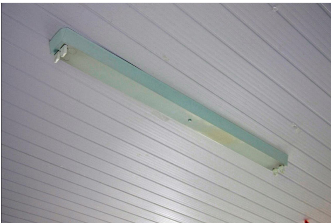
Muitas lâmpadas queimadas por problemas na rede elétrica
