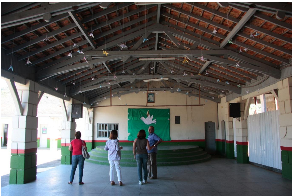
Necessidade de reforma no telhado do galpão coberto devido às goteiras
