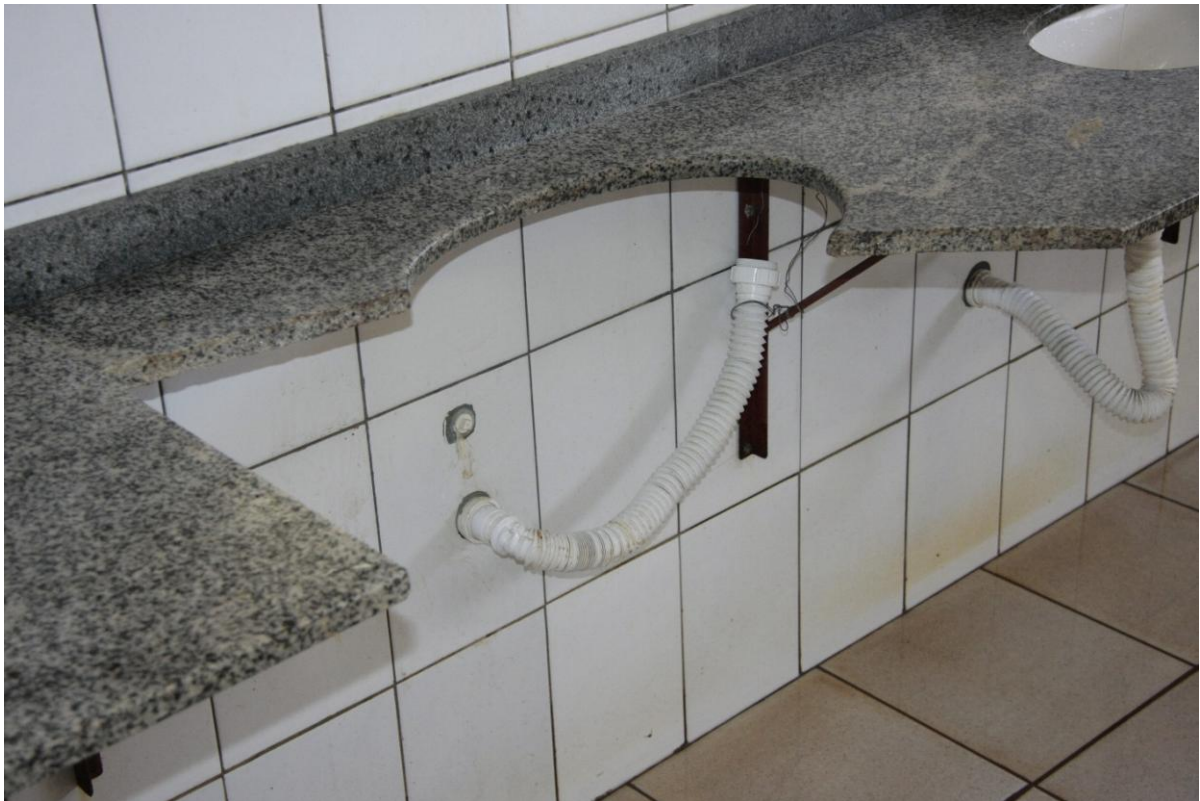
Banheiros necessitando de reforma
