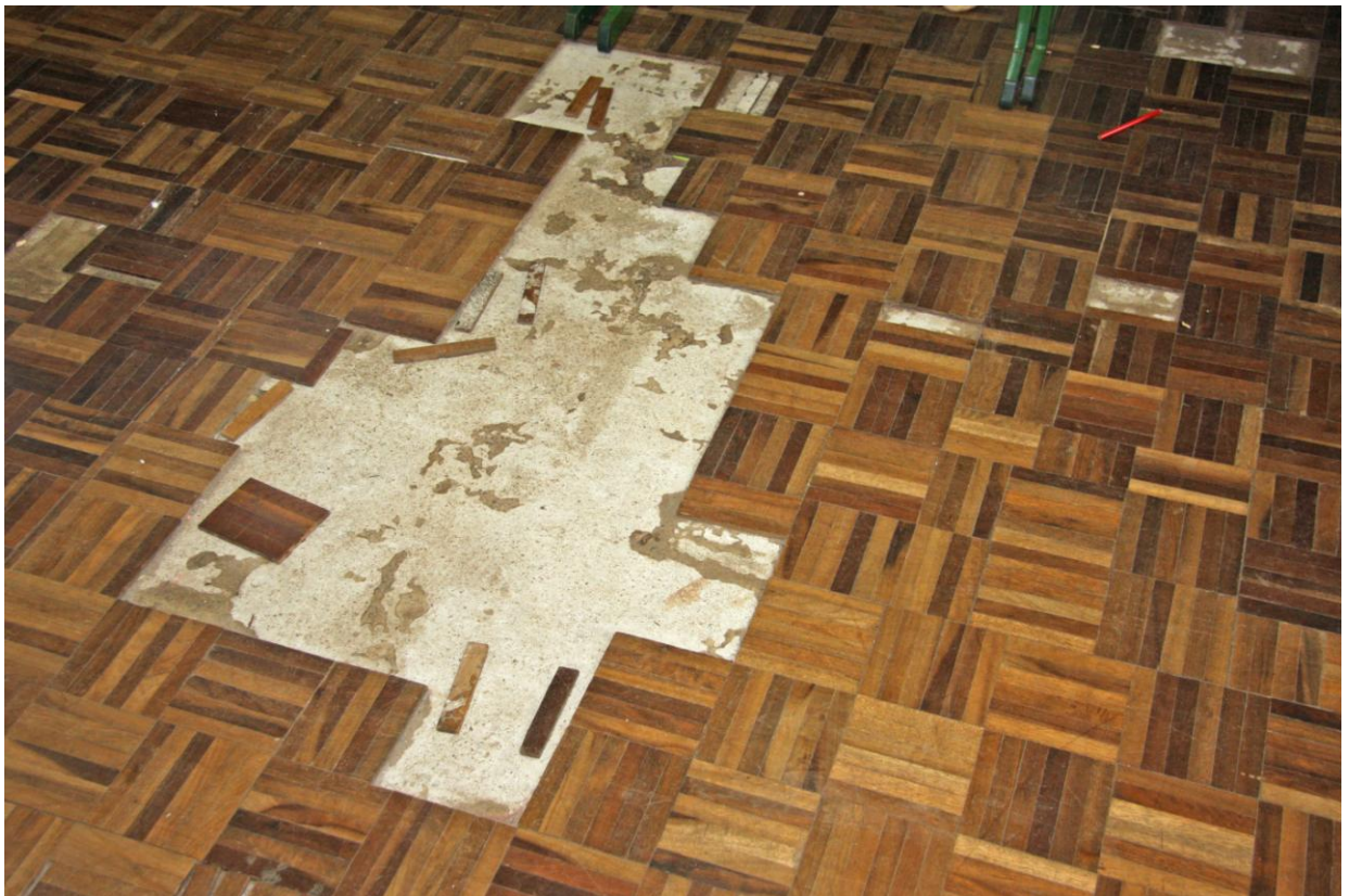
Pisos de taco se soltando nas salas de aula
