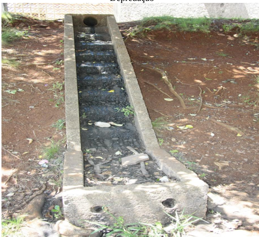
Esgoto correndo a céu aberto no pátio da escola
