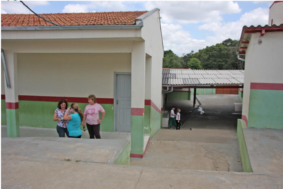
Falta cobertura na ligação de uma ala à outra
