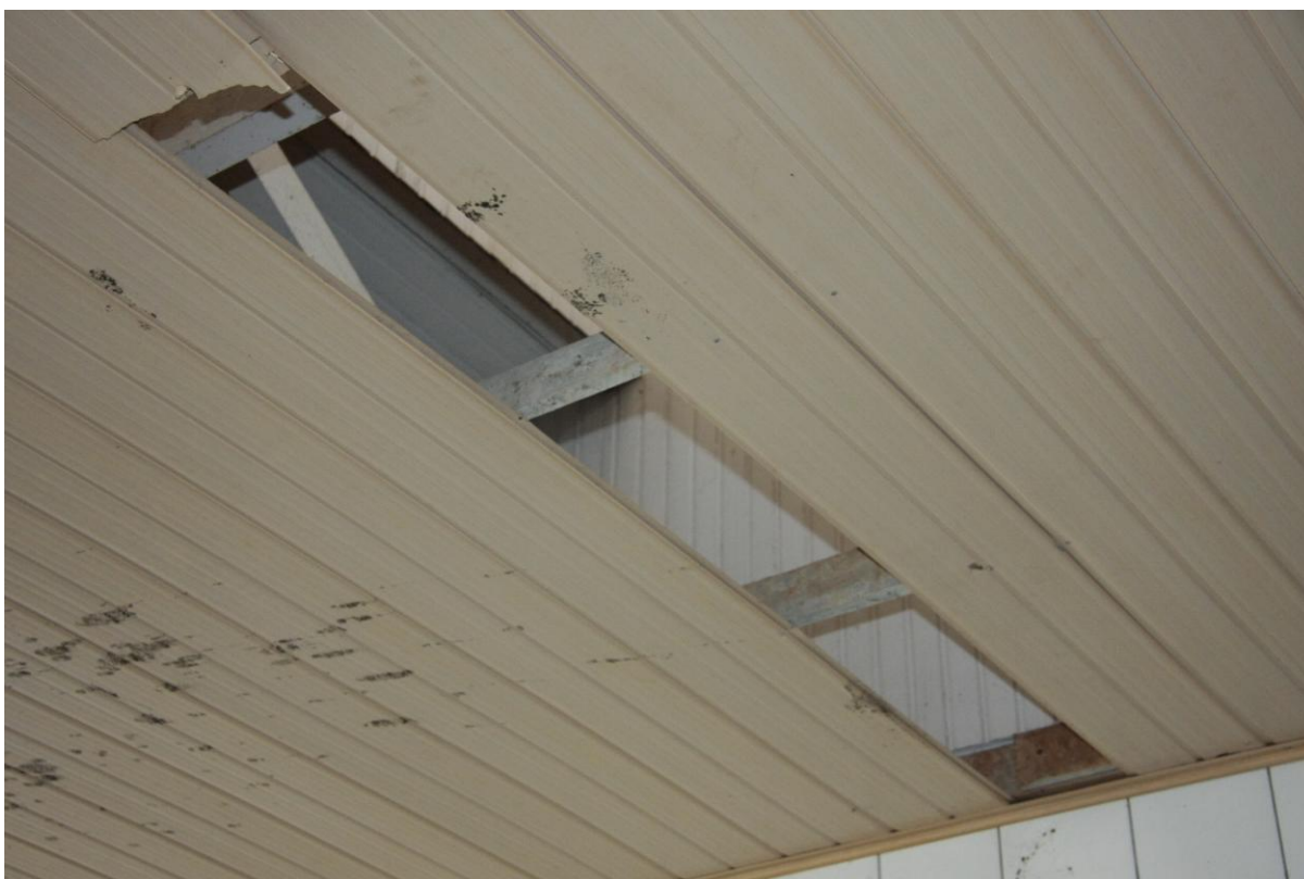
Forro das salas de aula caindo
