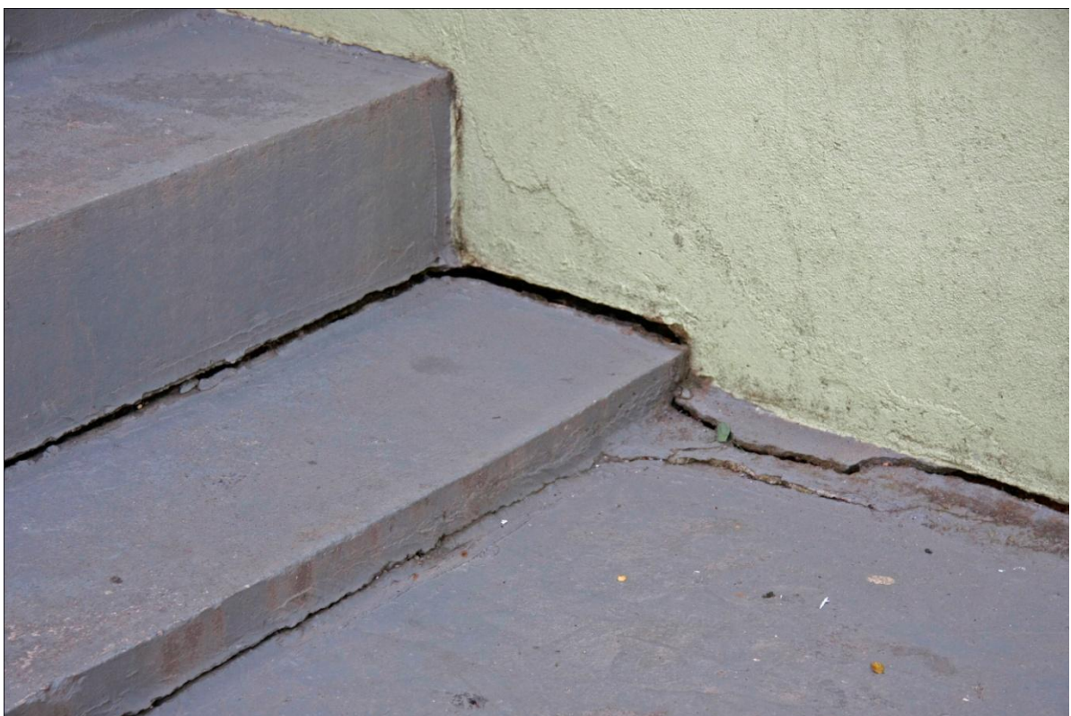
Estrutura do prédio comprometida com sérias rachaduras
