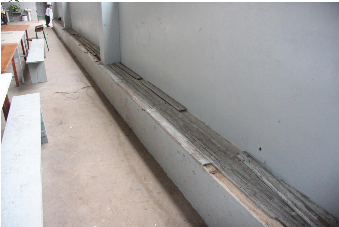
Bancos do refeitório com madeiras soltando e com pregos à mostra
