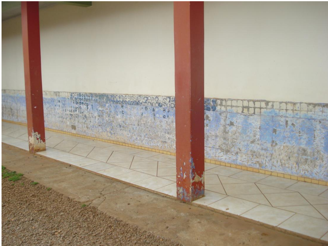
Ladrilhos caindo em todo corredor
