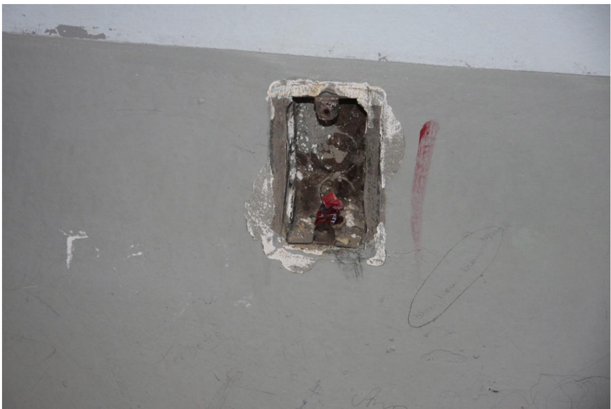
Rede elétrica comprometida, caindo muitas vezes
