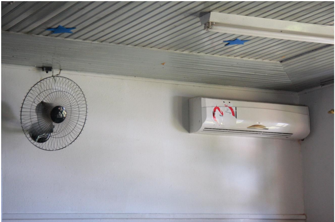
Climatizadores instalados em todas as salas de aula, mas fora de funcionamento devido às precárias condições da rede elétrica
