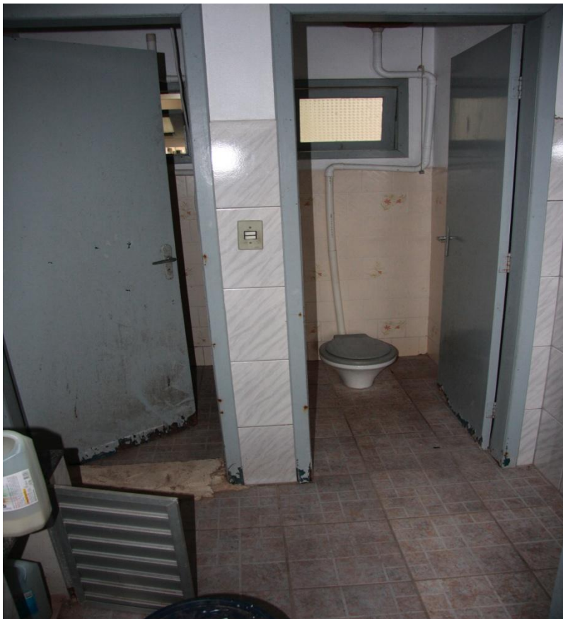
Banheiro desativado do laboratório
