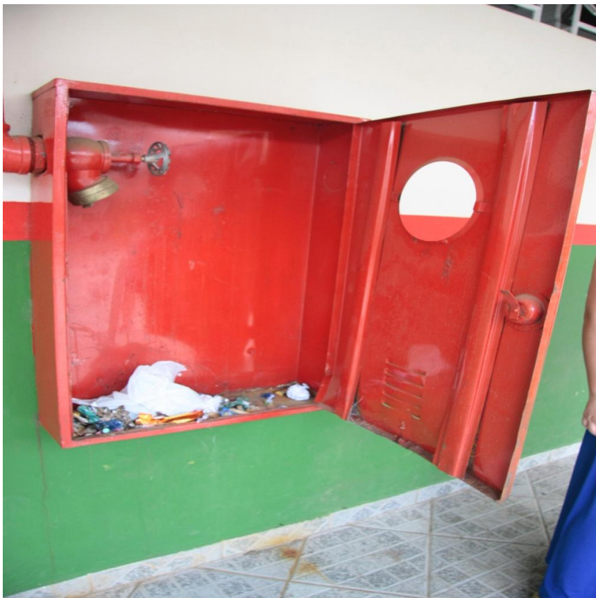
Faltam equipamentos de incêndio
