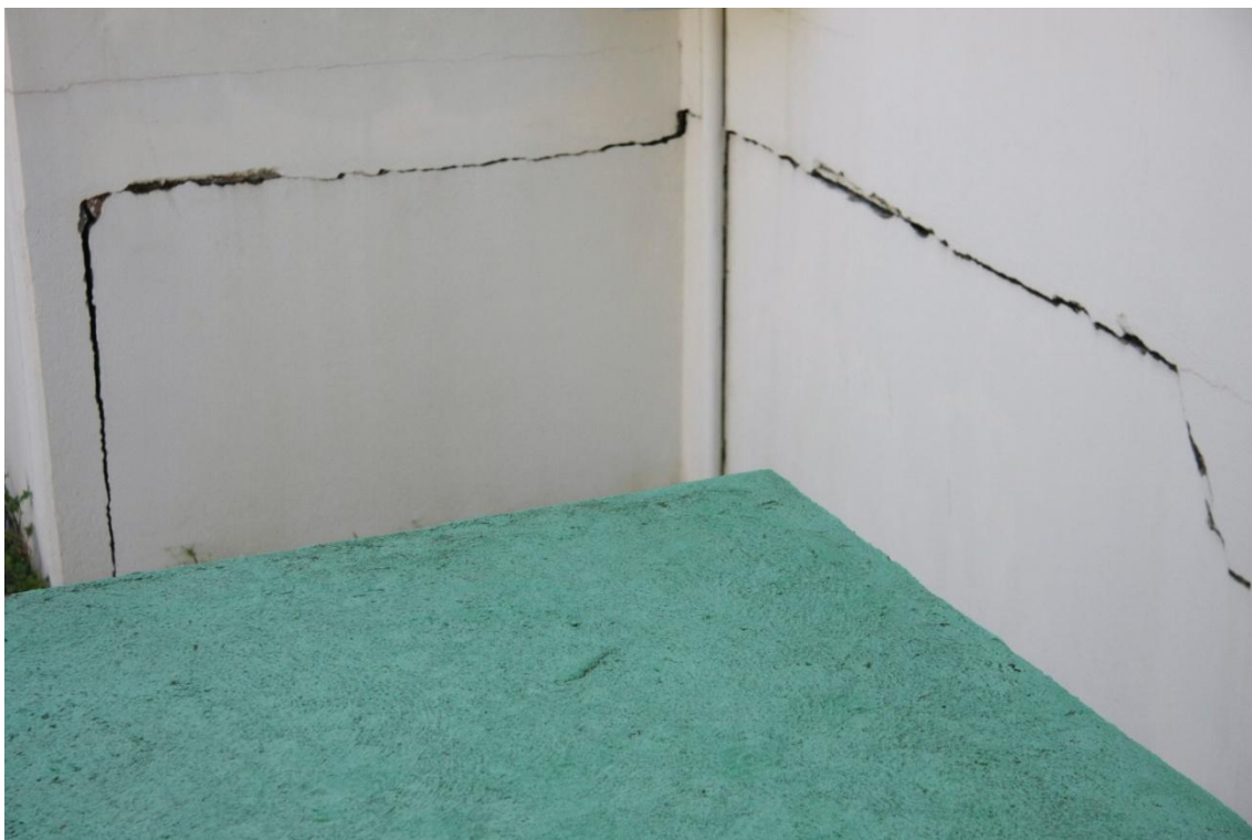
Fendas na parede externa do auditório
