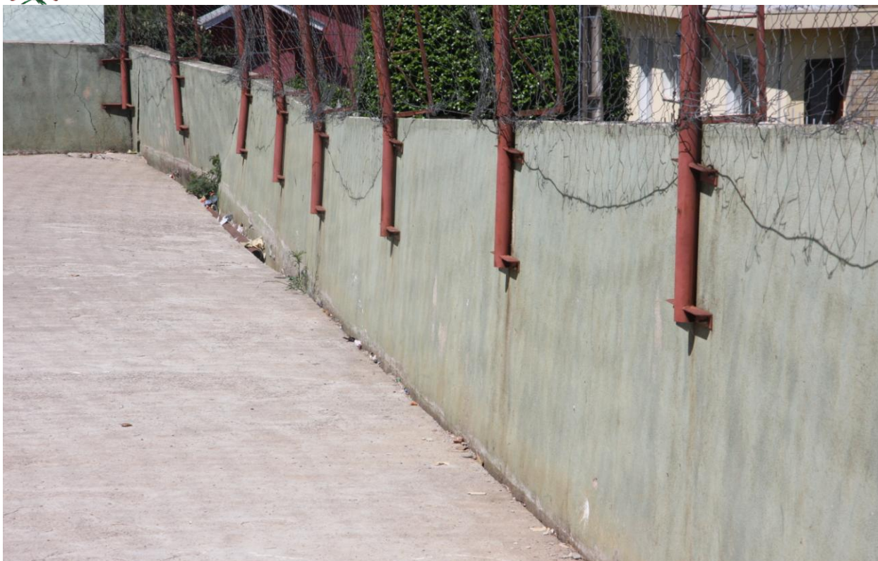
Muro da quadra descoberta caindo e piso de cimento
