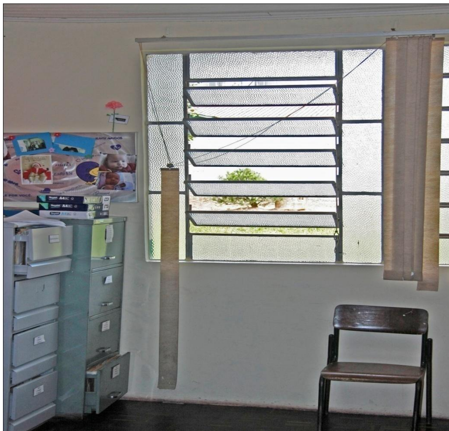
Cortinas das salas estão quebradas permitindo a entrada de sol
