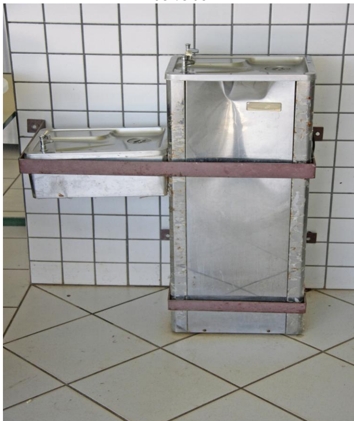
Bebedouro em situação crítica, com vazamentos
