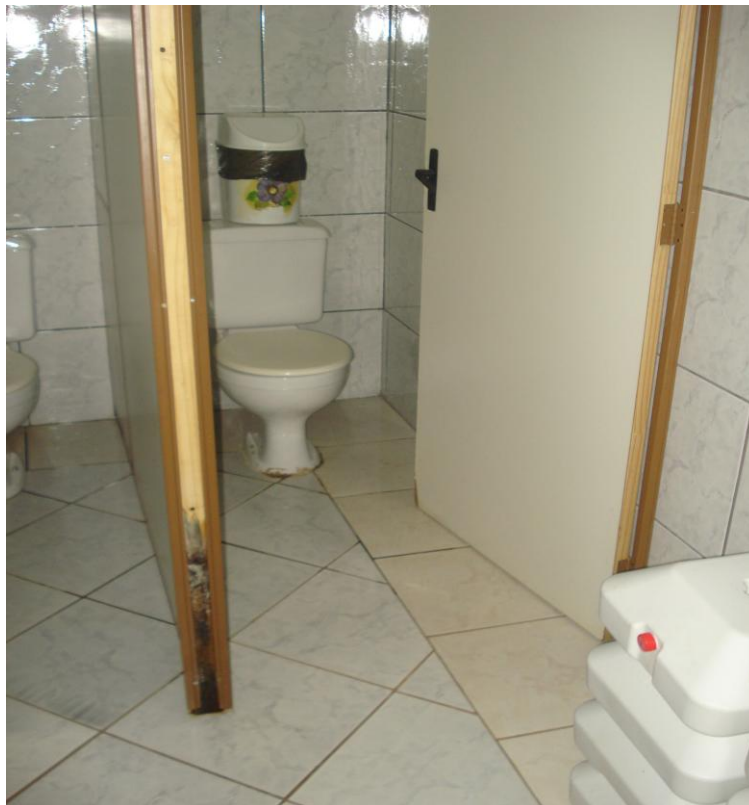
Banheiro dos professores e profissionais administrativos com problemas de encanamento
