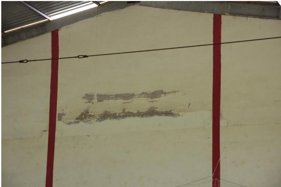
Infiltrações nas paredes do ginásio
