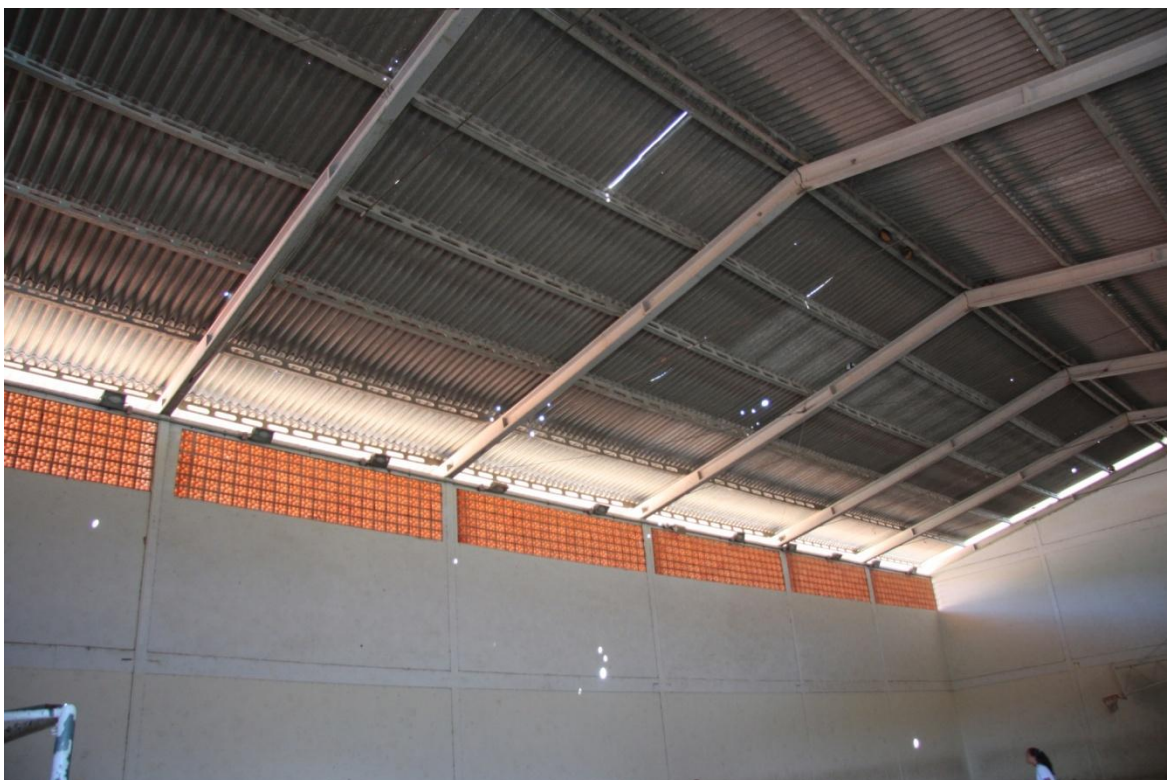
Telhado da quadra coberta atingido por granizo necessitando de reforma
