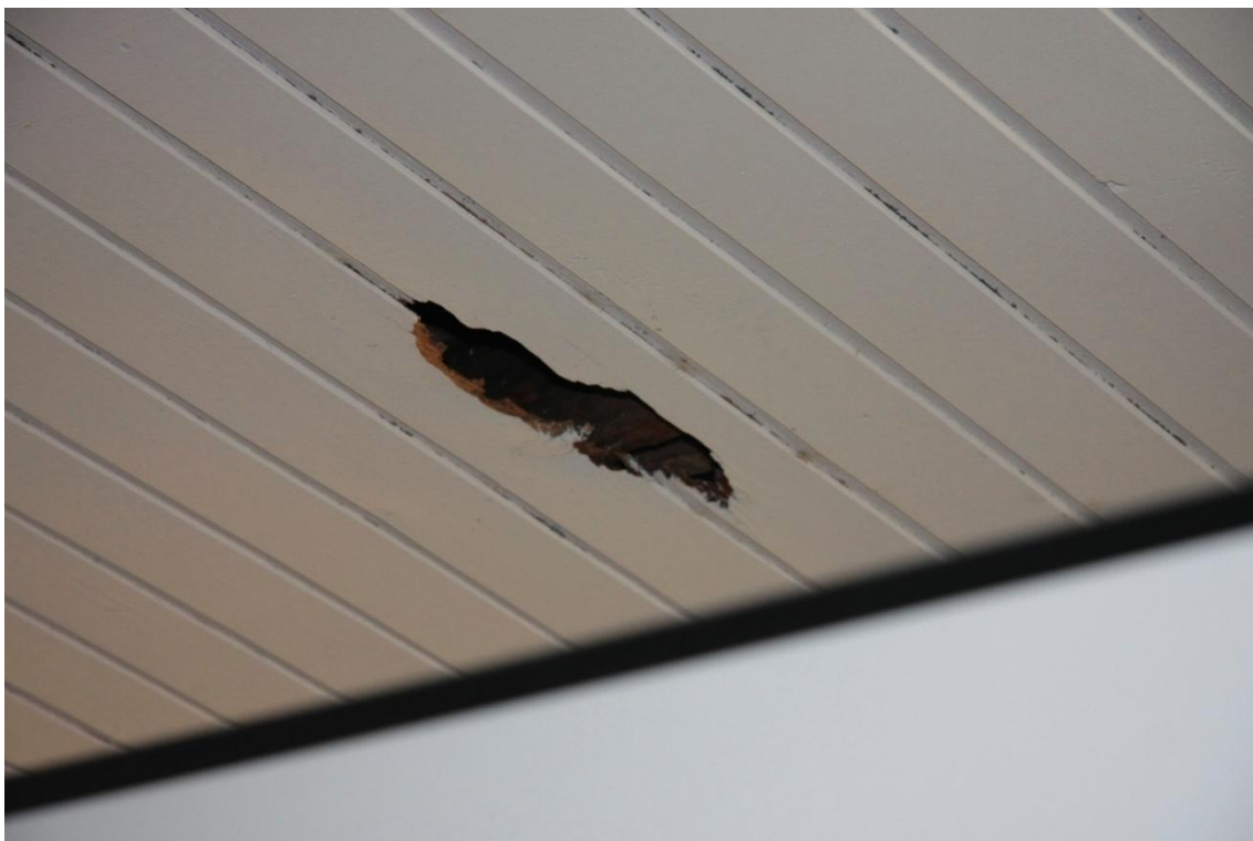
Forro podre e infestado de cupim
