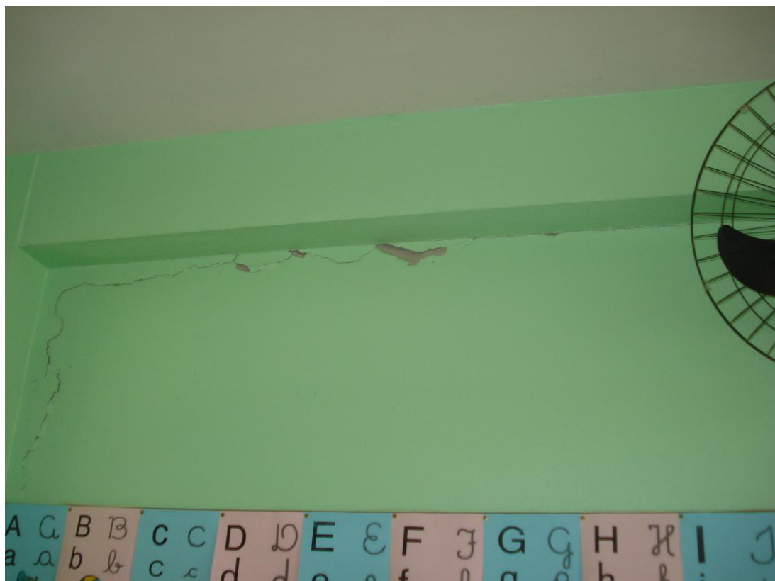
Rachaduras na estrutura do prédio.
