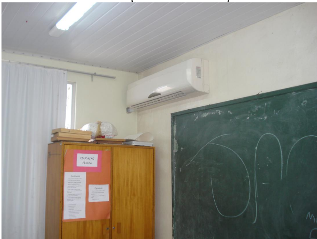
Climatizadores em todas as salas de aula, porém não podem ser ligados em virtude das péssimas condições da rede elétrica.
