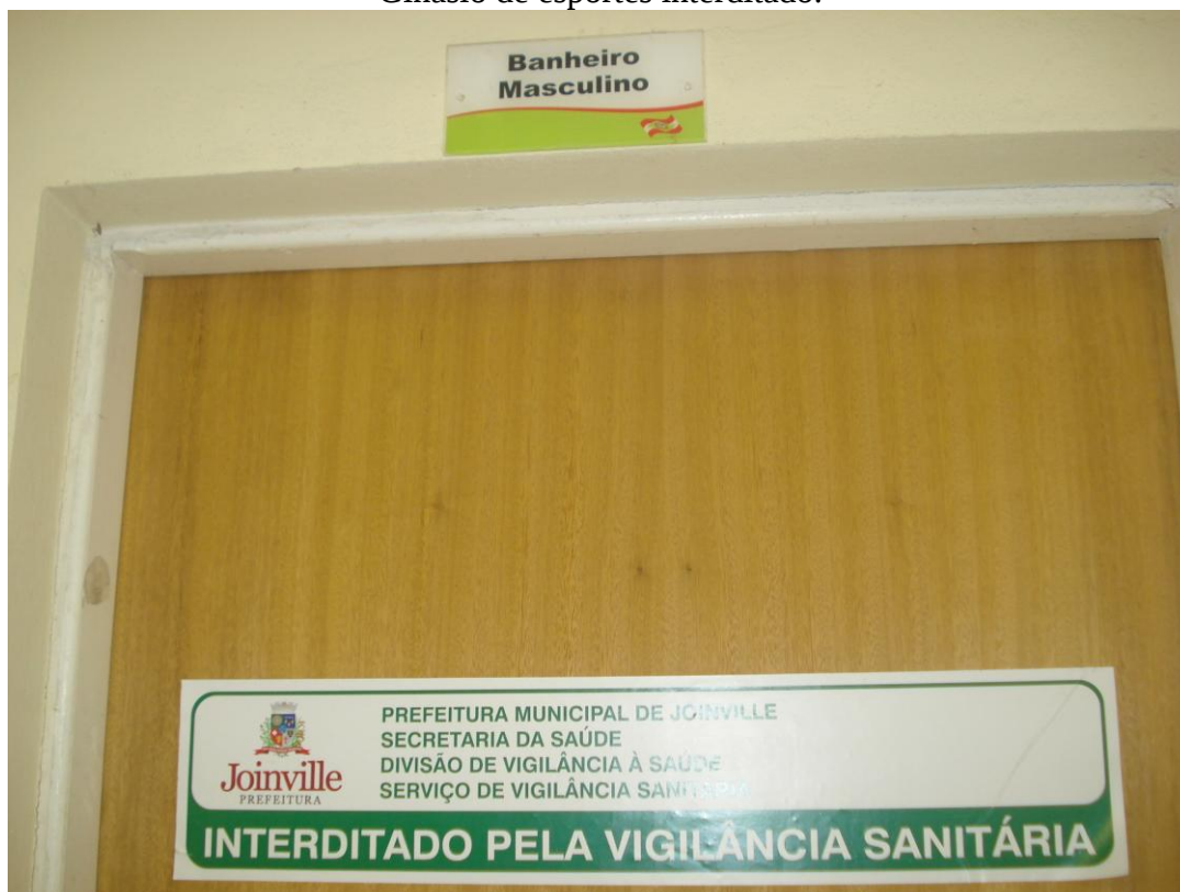
Banheiro masculino interditado por causa de vazamento.
