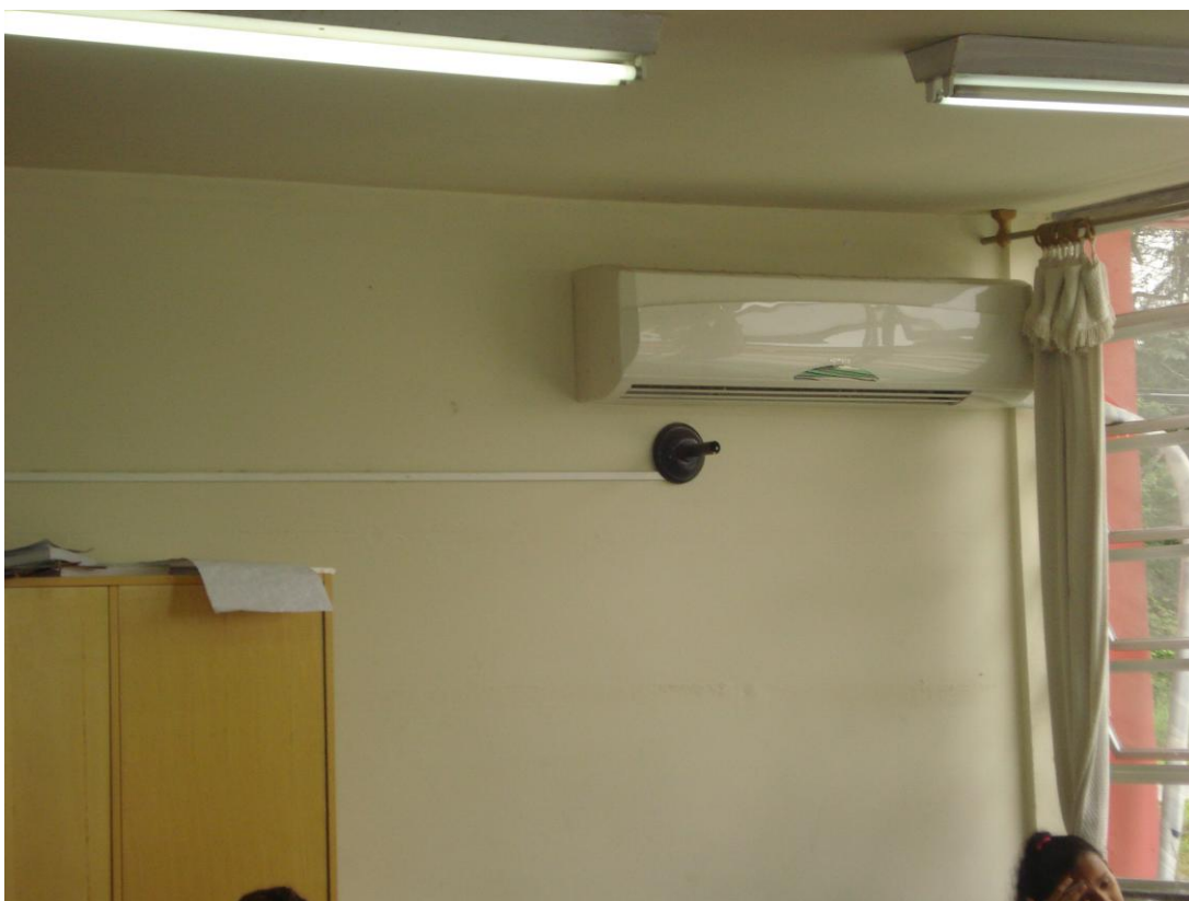
Climatizadores colocados nas salas de aula, porém a rede elétrica não comporta a instalação.
