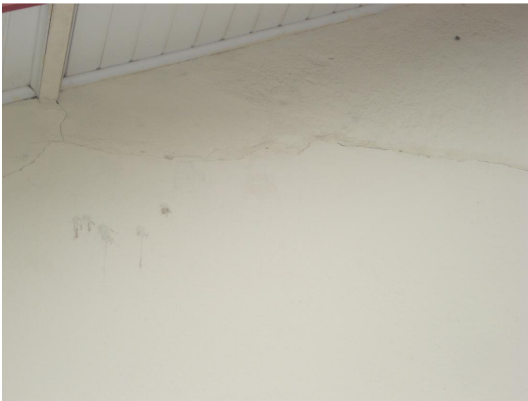
Rachaduras na estrutura.
