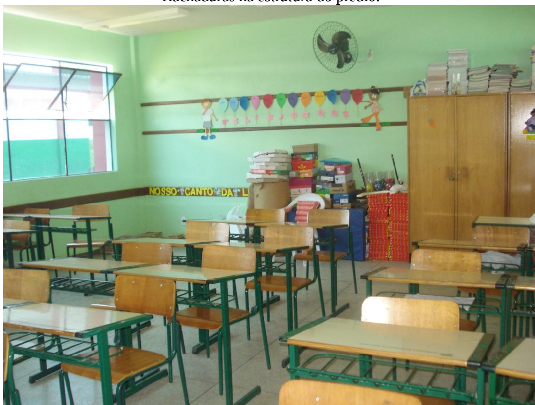
Janelas basculantes abertas para cima dificultando a colocação de cortinas.
