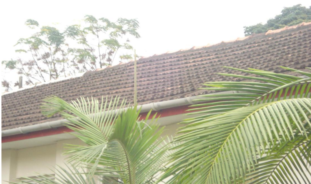
Problemas de infiltração no telhado.
