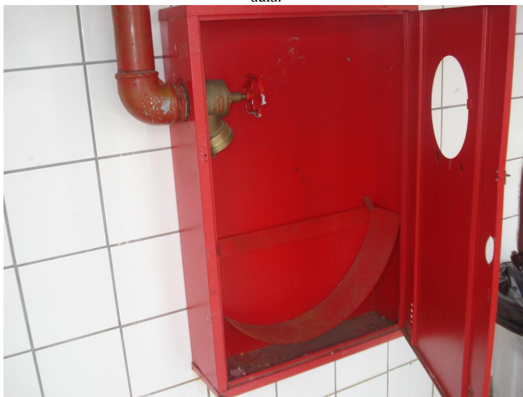
As mangueiras de incêndio foram retiradas por causa do vandalismo.
